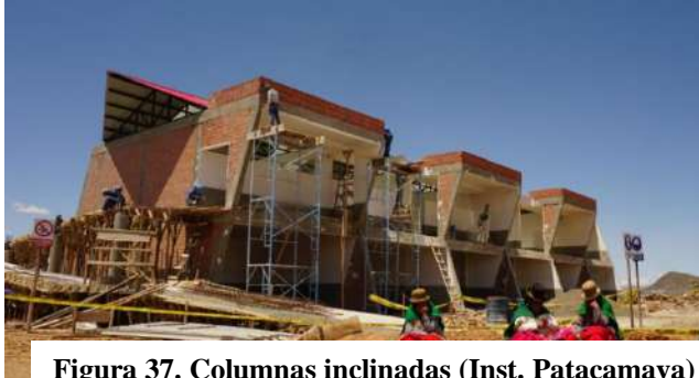
Figura 37. Columnas inclinadas (Inst. Patacamaya)
