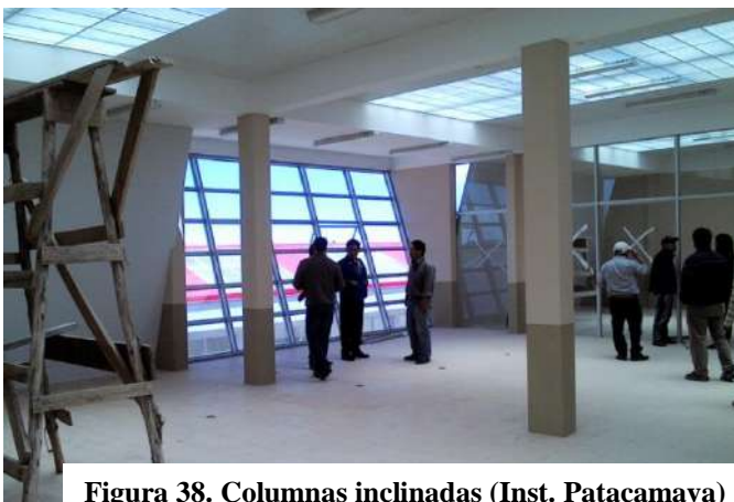
Figura 38. Columnas inclinadas (Inst. Patacamaya)
