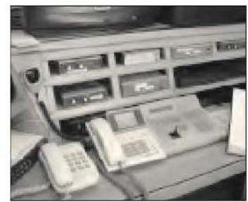
Central de seguridad
