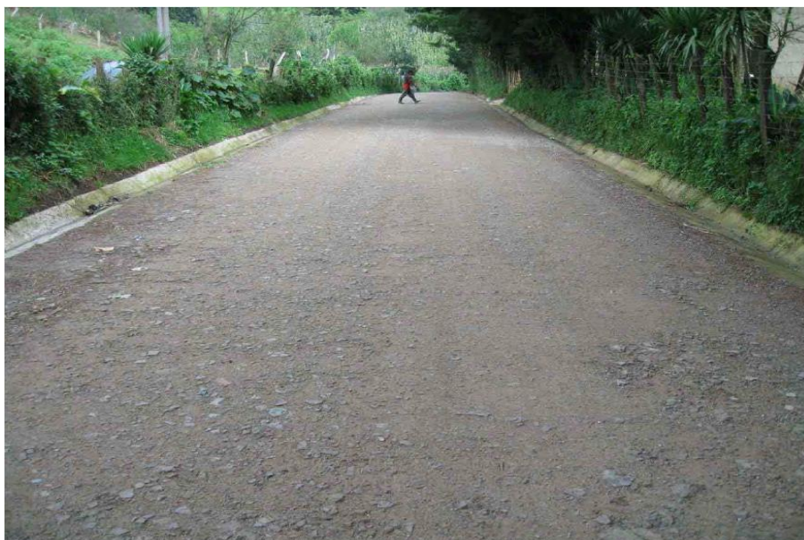
Figura 26 Tramo Río Chiquito, Las Pilas (2003)
