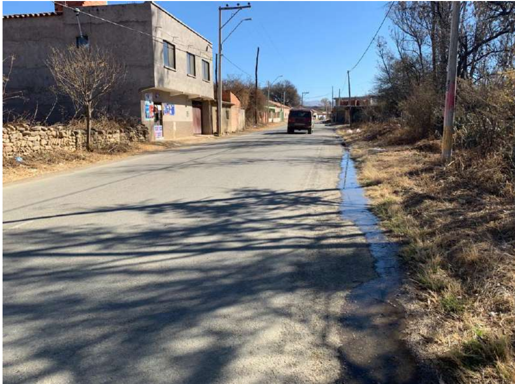
Escurrencimiento superficial del agua sobre la calzada
