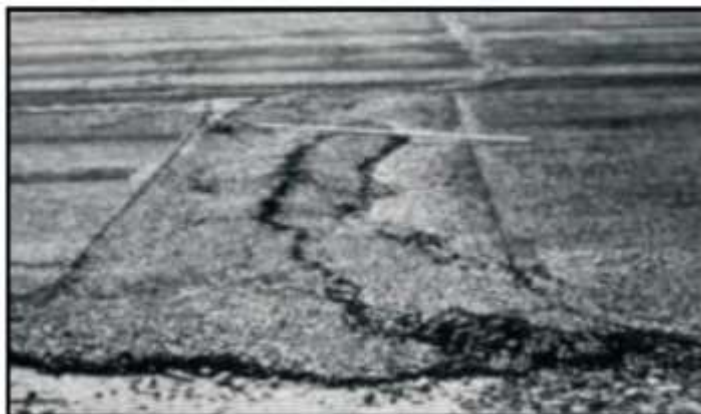
Imagen 2.9:17 Hinchamiento de alta severidad.
