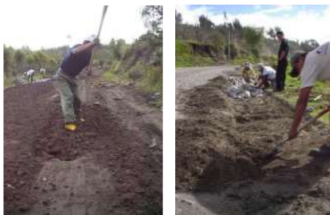
Imagen 2.3:3 Disgregación de Subrasante
