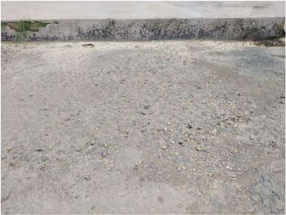
Desprendimiento de agregados
