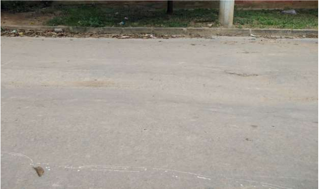
Abultamiento y hundimiento
