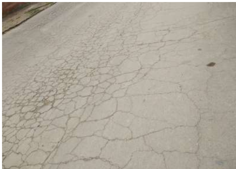
Agrietamiento en bloque
