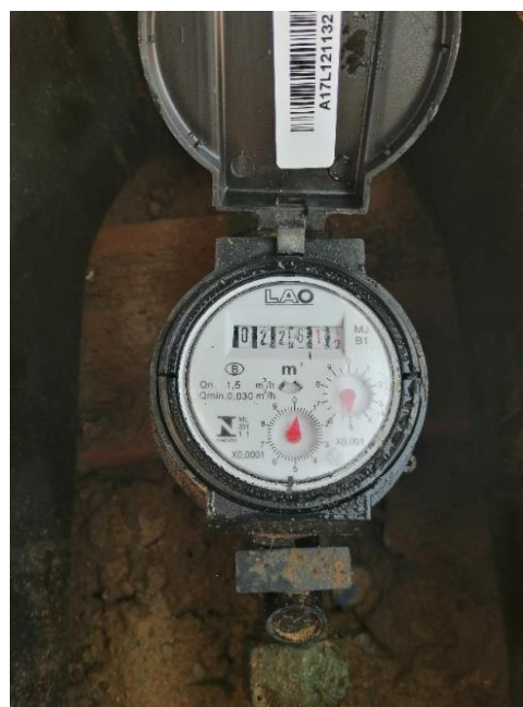
Fotografía N° 2: Realizando lectura del medidor
