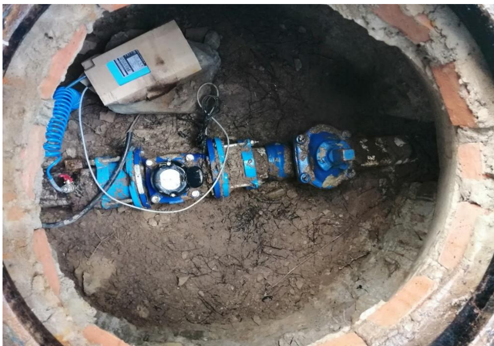
Fotografía N° 2 Macromedidor ubicado en el ingreso de la red
