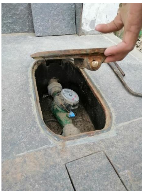
Fotografía N° 1: Inspección de funcionamiento de micromedidores
