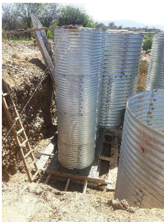
Figura 4. 7. Tanques sostenidos por alambres
