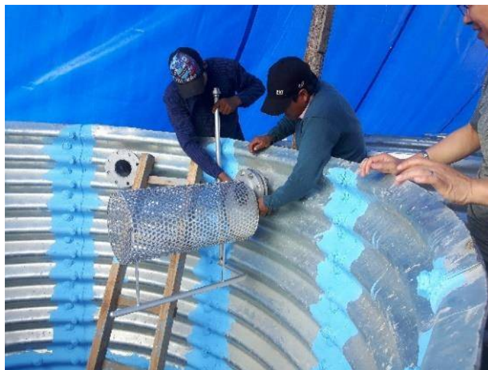
Figura 4. 23. Colocación de cribas para evitar el paso de medias
