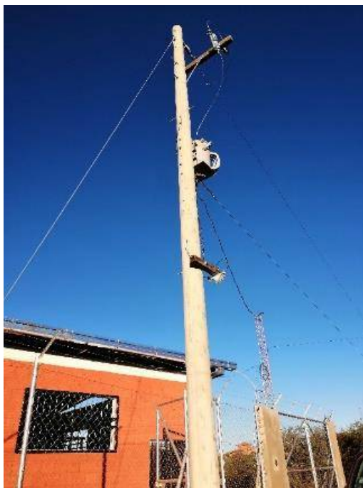
Figura 4. 31. Suministro la energía eléctrica requerida, por parte de Servicios Eléctricos de Tarija ( SETAR)
