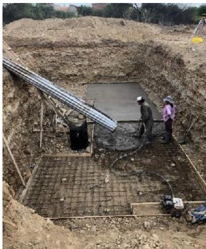
Figura 4. 4. Cimientos de concreto armado para la instalación de los tanques de acero galvanizado
