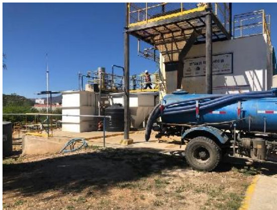
Figura 5. 18. Recogida de lodo de la PTAR de la cervecería
