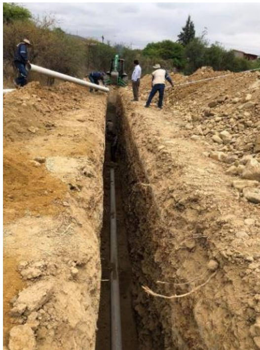
Figura 4. 10. Tendido de tubería de 8" desde la cámara existente hacia el tanque de ecualización pasando por una nueva cámara
