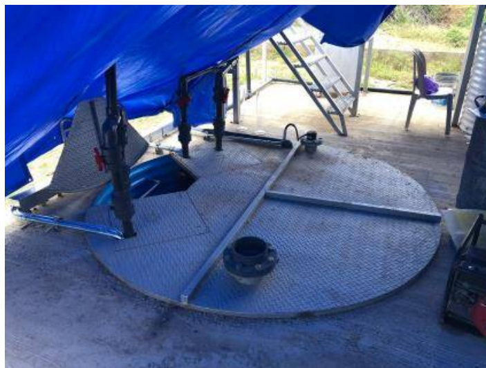
Figura 4. 34. Tanque de Ecuación
