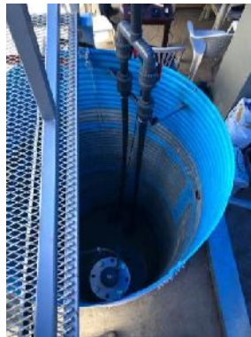
Figura 4. 40. Tanque de Almacenamiento de Efluente
