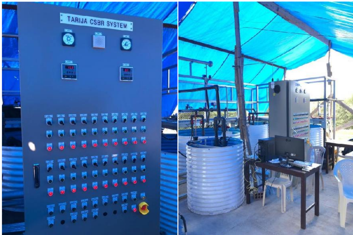
Figura 4. 57. Panel de control en la PTAR de demostración en el barrio Catedral
