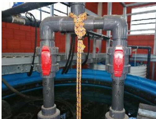
Figura 4. 51. Válvula de Tanque SBR
