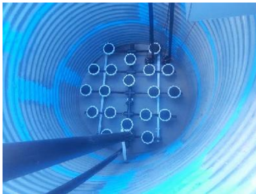
Figura 4. 46. Aireación del Tanque SBR
