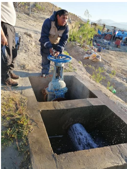
Foto 9 Abriendo la llave de la sección de control
