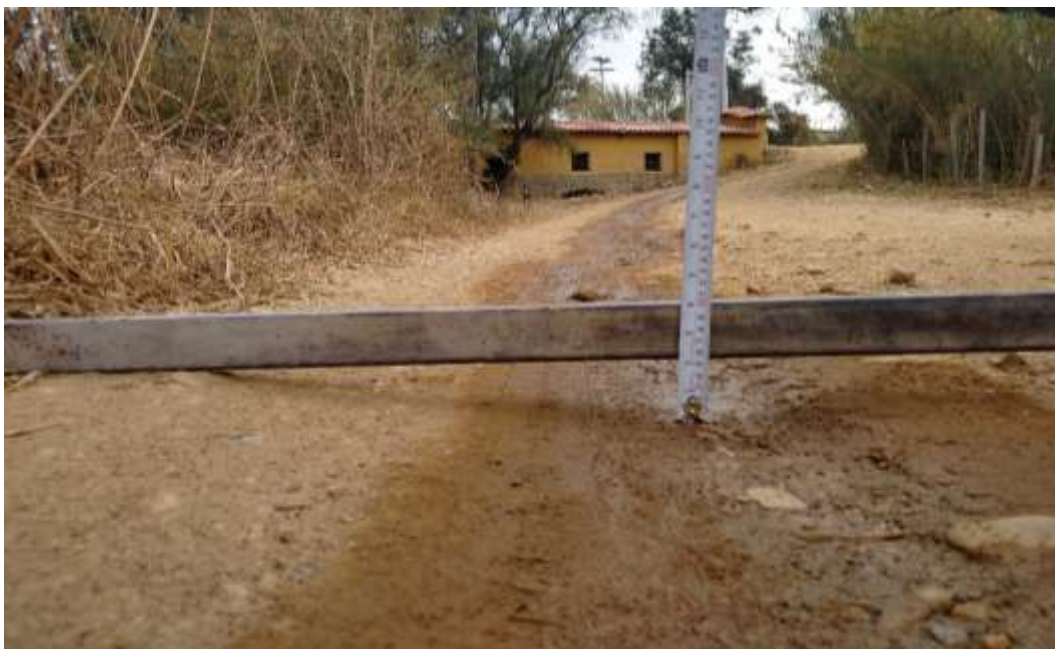
Surcos de rueda y Sección transversal impropia
