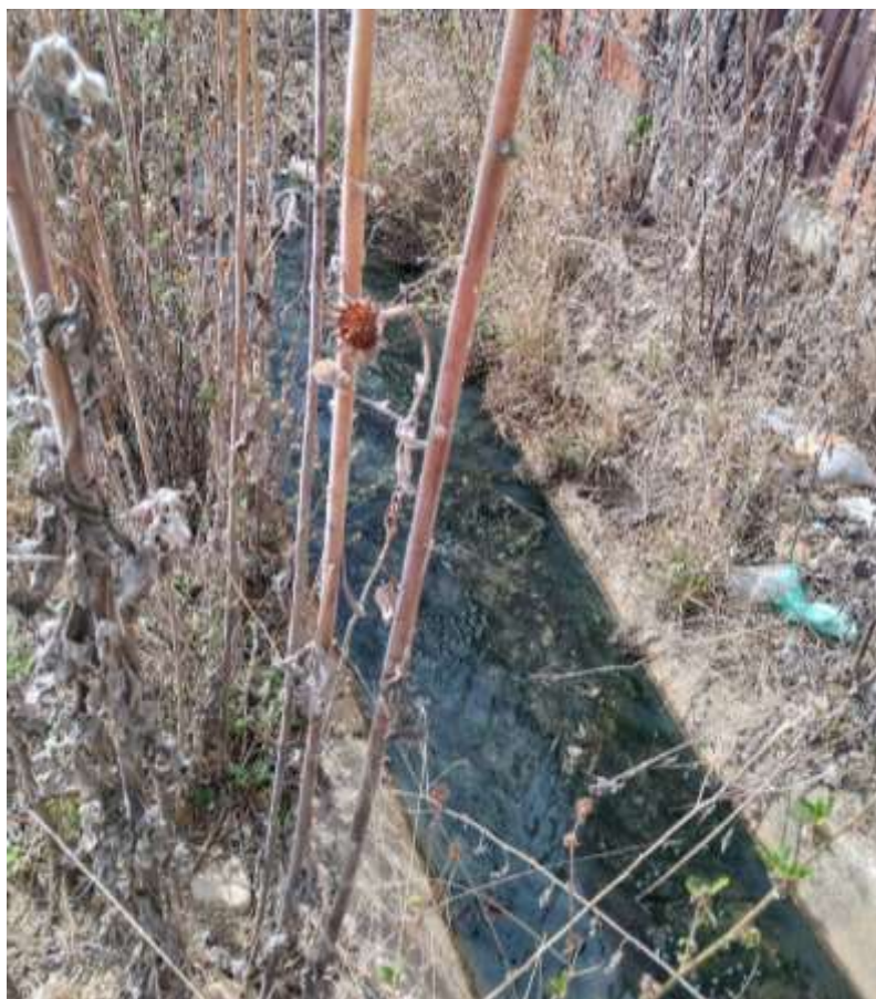
Estancamiento de aguas en cuneta por falta de mantenimiento
