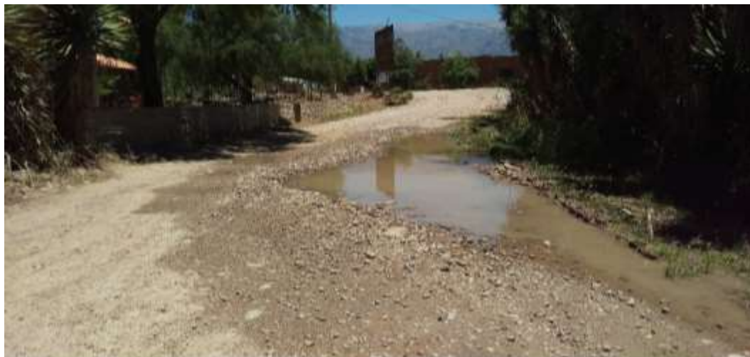
Acumulación de aguas debido al drenaje inadecuado
