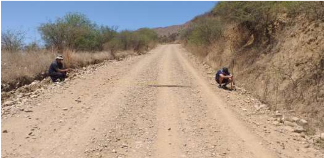
Medición de ancho de carril y Pérdida de agregado
