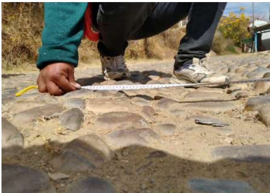
Fajas del empedrado con asentamiento
