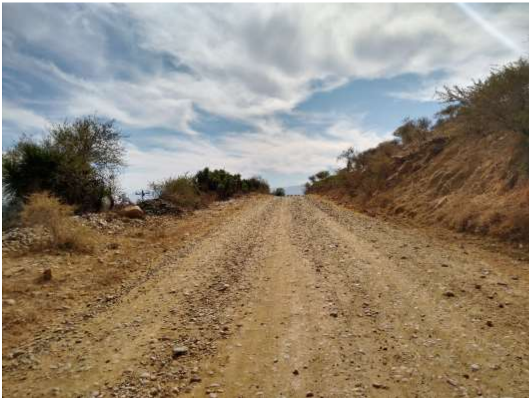
Pérdida de agregado
