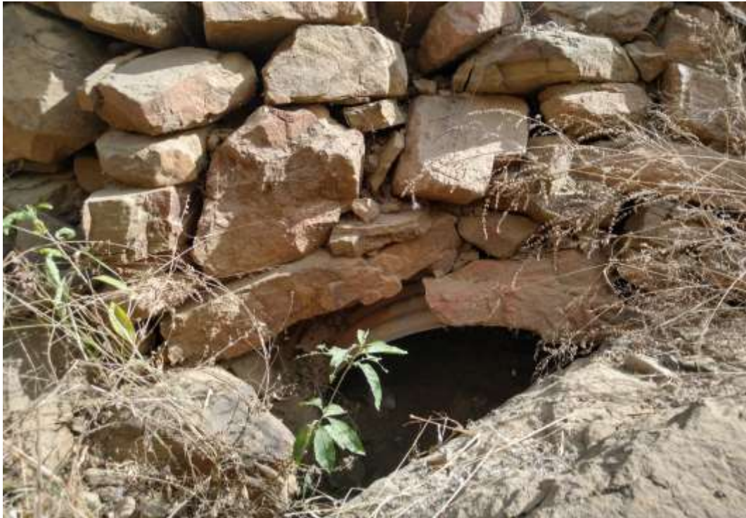
Alcantarillado circular sin mantenimiento
