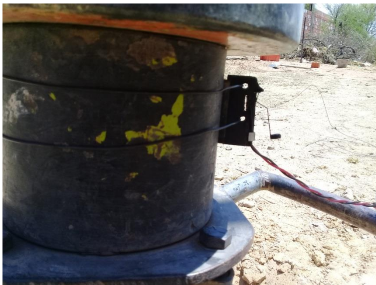
Interruptor inferior conectado al dispositivo.
