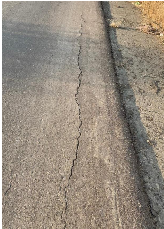
Fisura de borde
