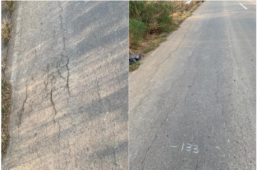
Grietas en bloque
