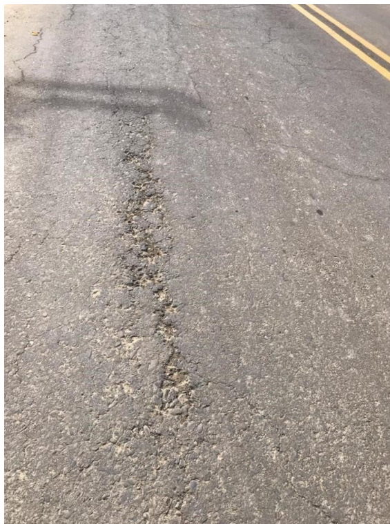
Desprendimiento de agregados
