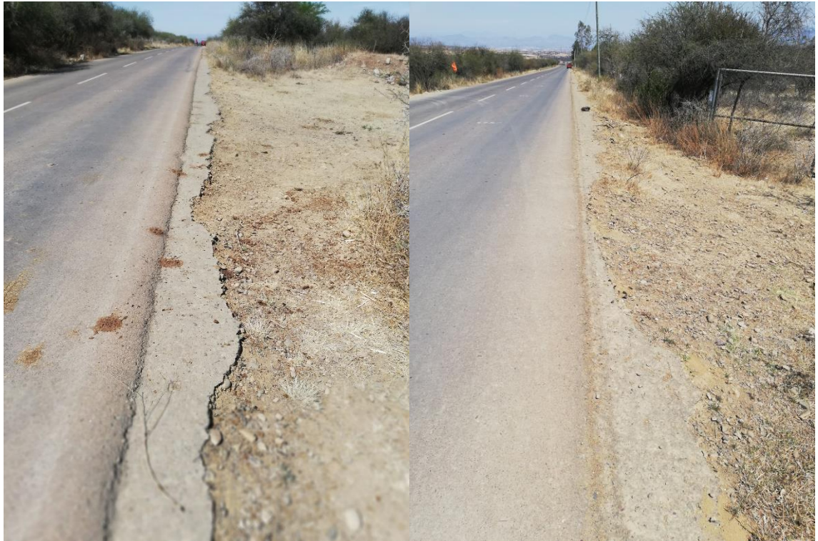
Desnivel carril Berma de severidad H
