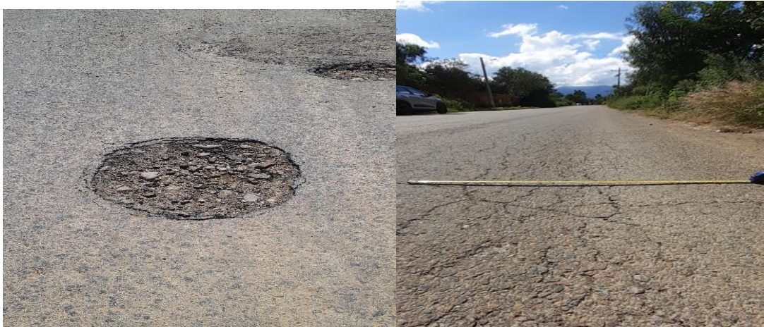
Figura N° 60 Identificación de fallas
