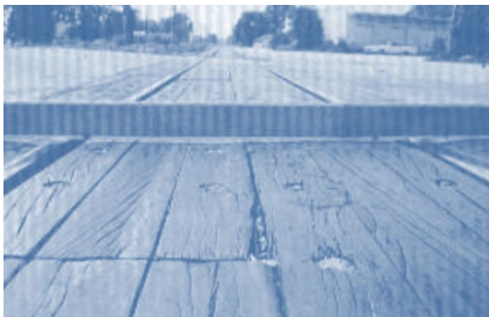
Figura N° 21 Cruce de vía férrea de baja severidad
