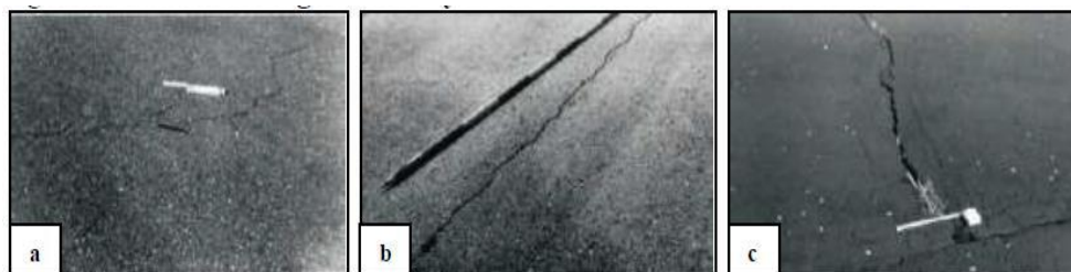
Figura N° 17 Grietas longitudinales y transversales
