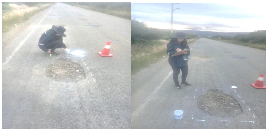
Figura N° 61 Medición de las fallas
