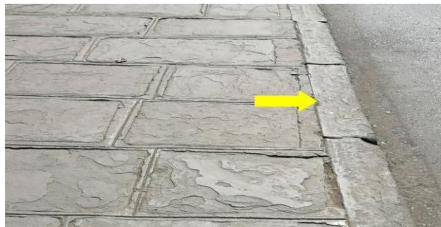
Figura 2. 29 Cordón de acera sin demarcación
