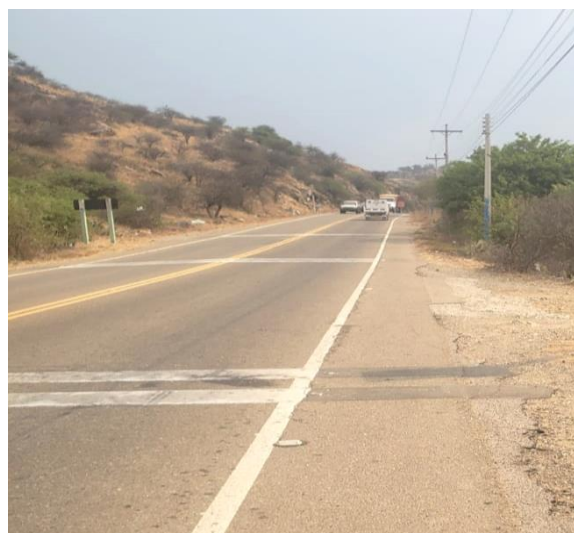
Figura N° 4.26 Reductores de velocidad en mal estado TCA 4
