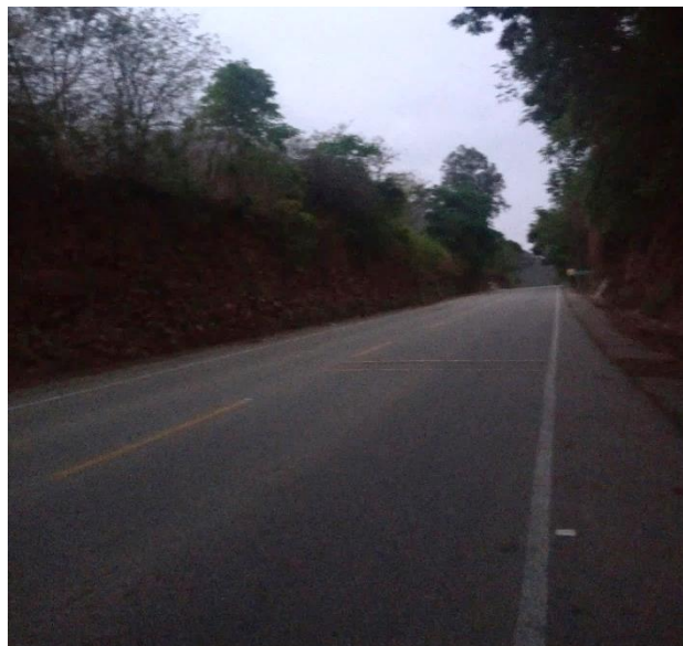
Figura N° 4.28 Falta de pintado y ojos de gato del TCA 4
