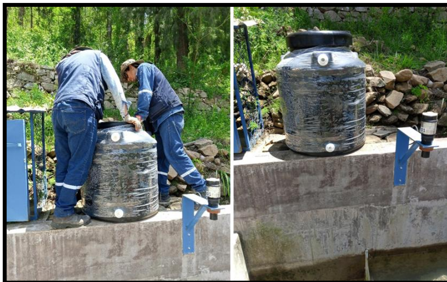
Figura 10 Disposición de tanque de hidróxido de calcio.
