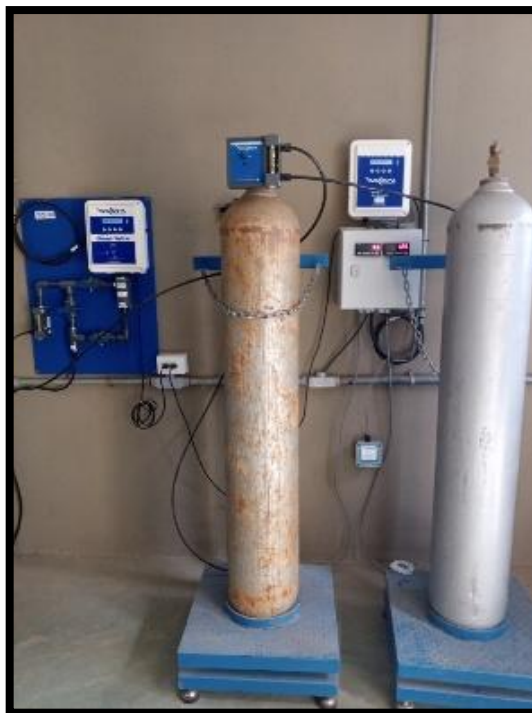
Figura 12 Dosificadores de cloro residual Hydro.
