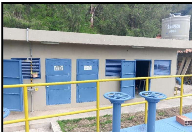
Figura 8 Sala de dosificación de la coagulación.
