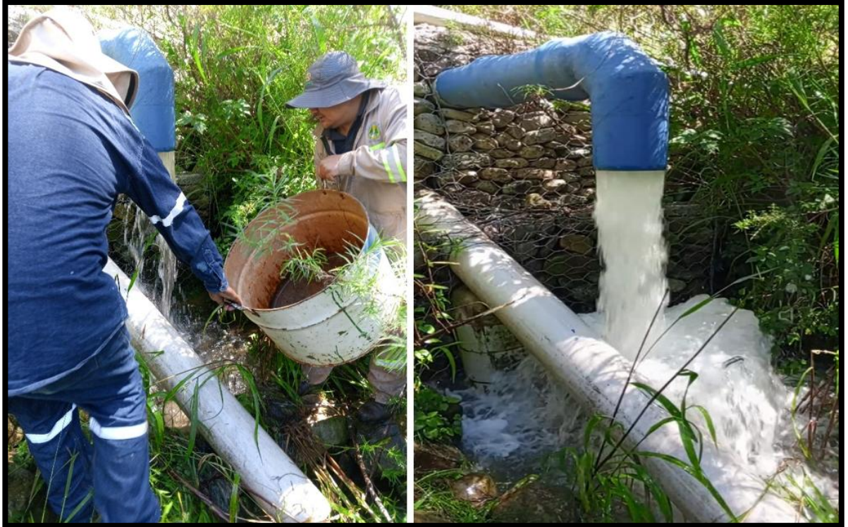
Figura 24 Aforo del lavado de filtros.
