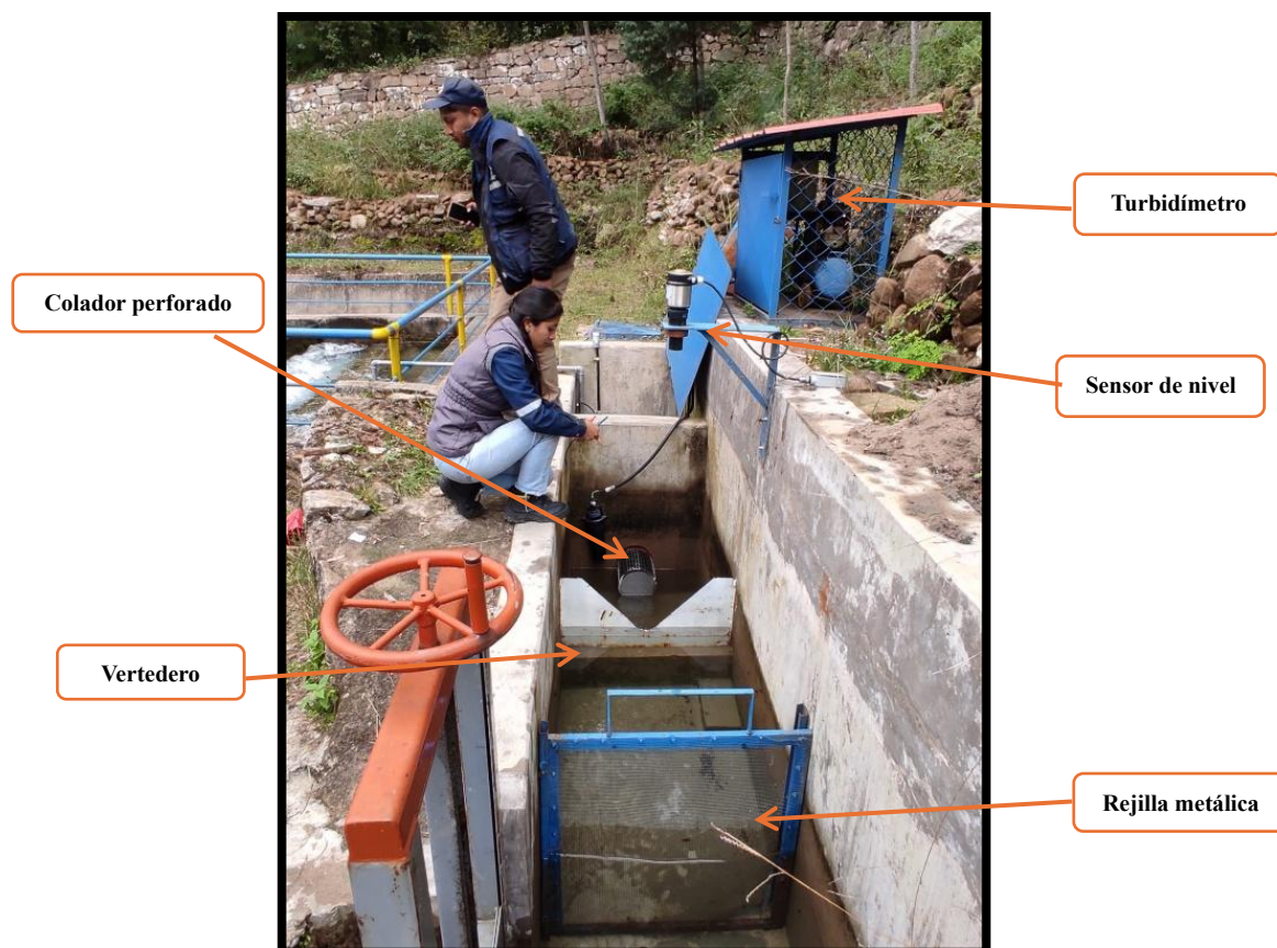
Figura 7 Ingreso de la Planta Potabilizadora Alto SENAC.
