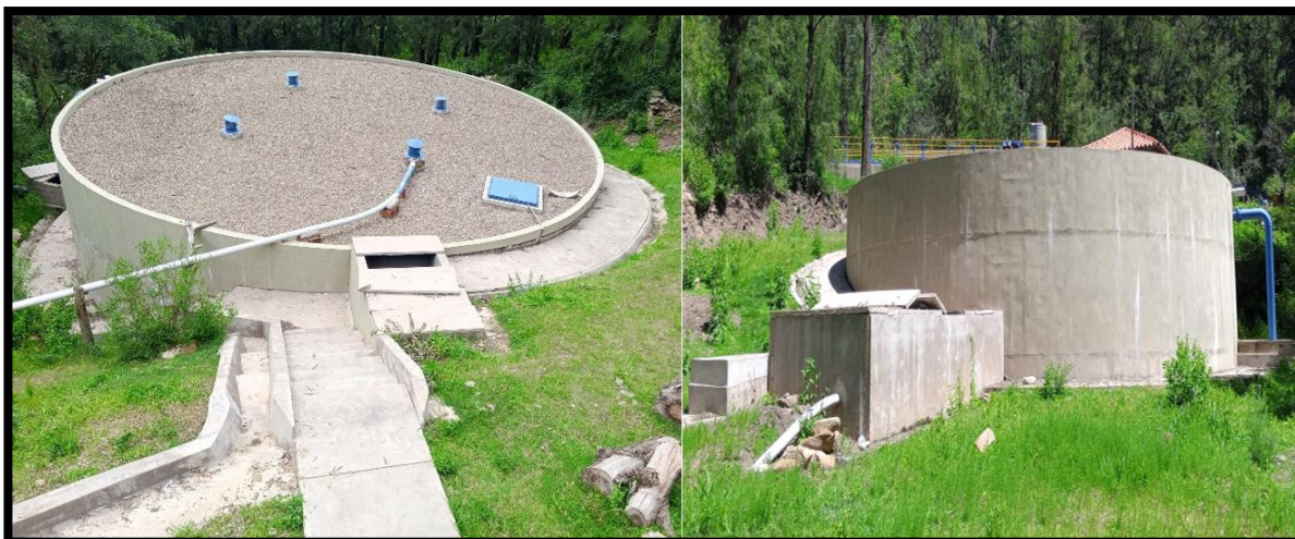
Figura 26 Tanque de almacenamiento.
