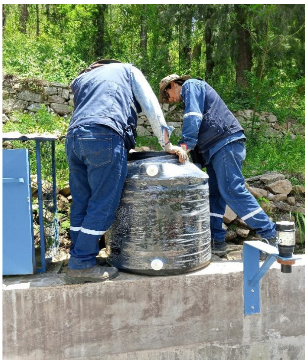
Modificación del punto de inyección de hidróxido de calcio aguas arriba del vertedero
