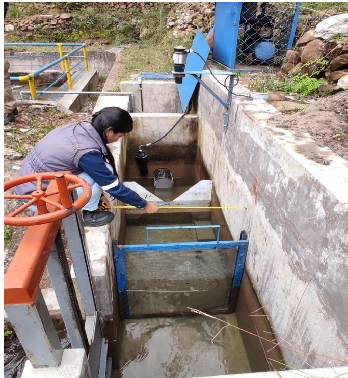
Pretratamiento: Canal de entrada, rejillas, vertedero, sensor de nivel y turbidímetro.
