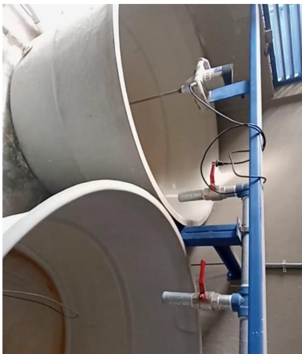
Tanques de mezcla rápida en la sala de dosificación.
