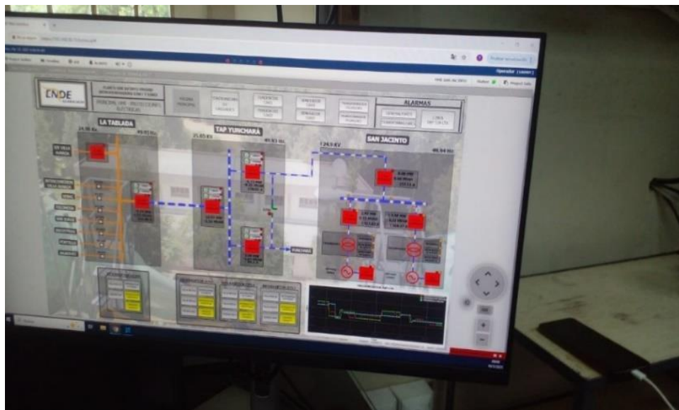
Figura 41: Sistema Scada de la Central Hidroeléctrica. Fuente:” Central Hidroeléctrica San Jacinto “Fotografía del autor.
