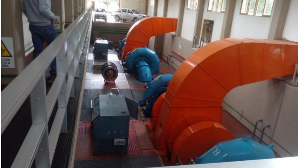
Figura 34: Ubicación de las Turbinas.
