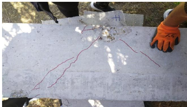
Figura 4.12 Fisuras por fallo a cortante
