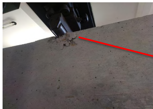
Figura 4.26 Fallo a compresión en cabeza superior de la viga
