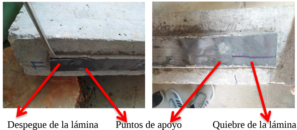
Figura 4.27 Despegue entre láminas de fibra de carbono y el epoxi
