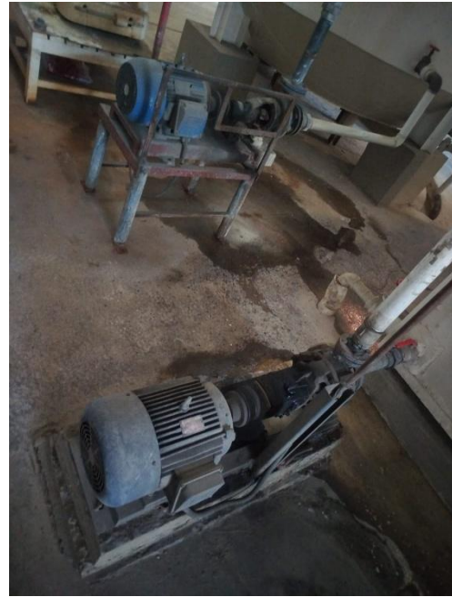
Figura 15 Bombas de tanques contenedores
