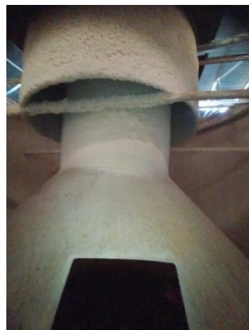
Figura 13 Campana interna del reactor
