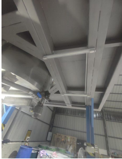
Figura 36.- Instalación de iluminación en área de envasado.
