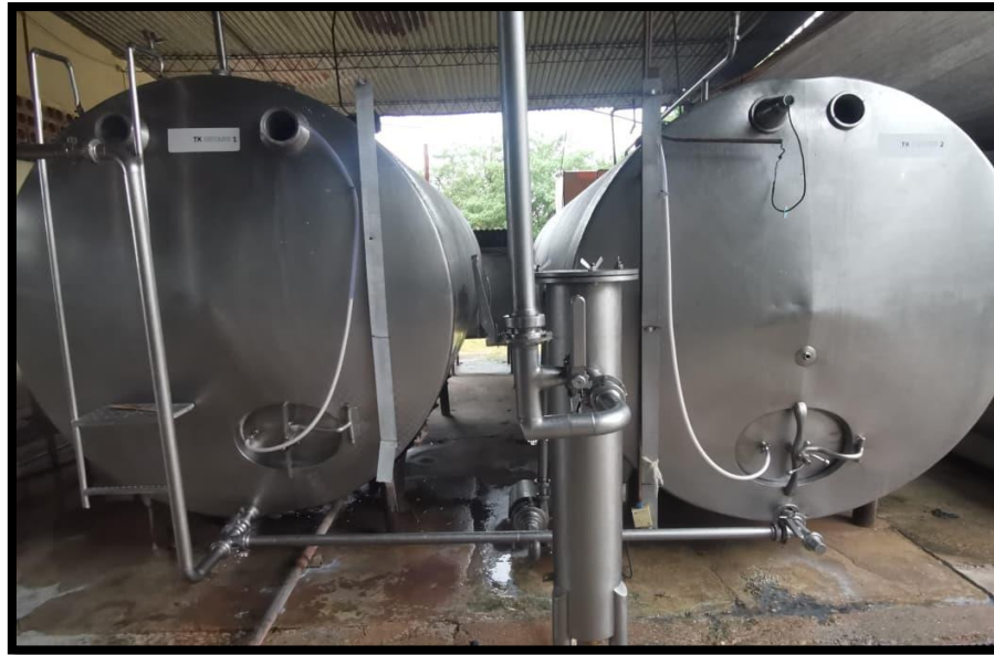
Figura 4-5. Tanques de recibo
