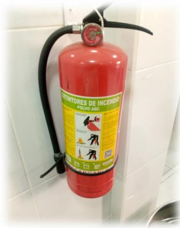
Extintor ABC de 6 Kg ubicado en el área de producción
