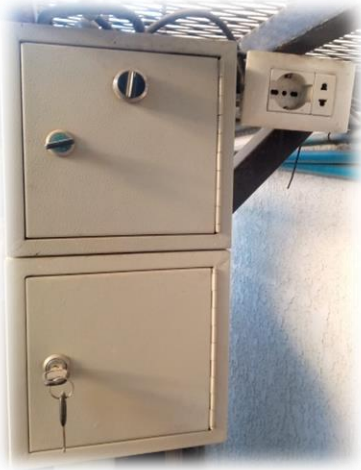
Tomacorrientes deficientes en el área de materia prima
