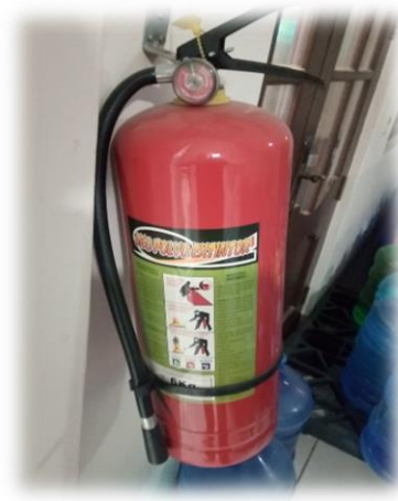
Extintor ABC de 6 Kg ubicado en el almacén
