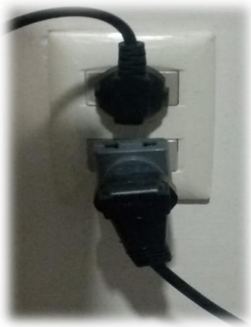
Tomacorrientes deficientes en el área de producción
