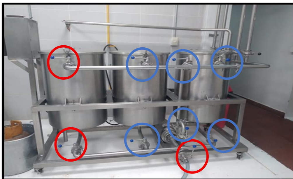
Tanques de limpieza CIP
