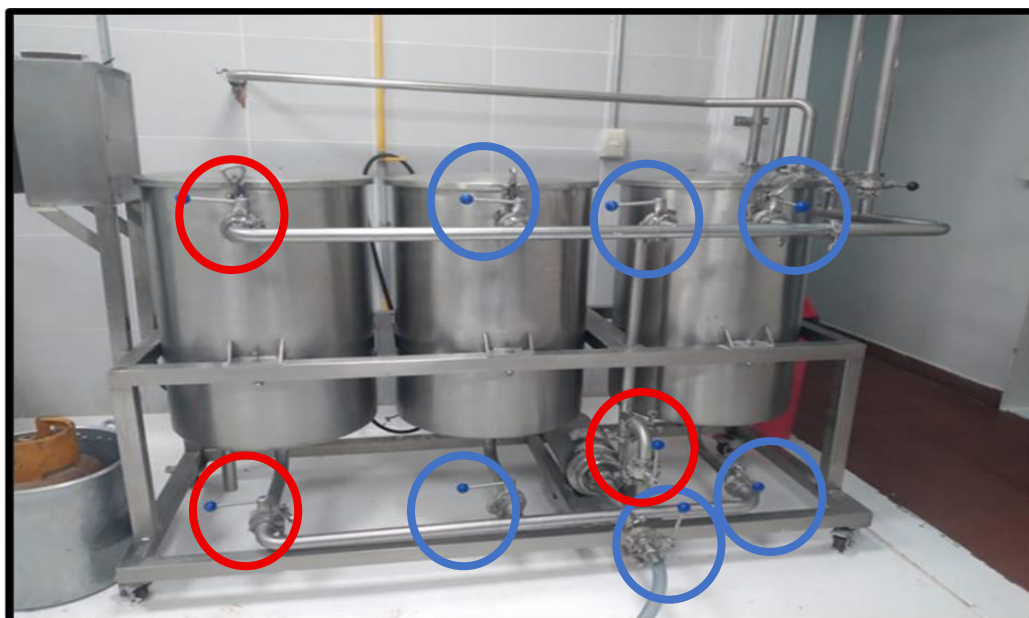
Tanques de limpieza CIP
