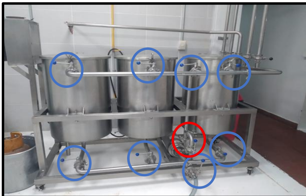
Tanques de limpieza CIP
