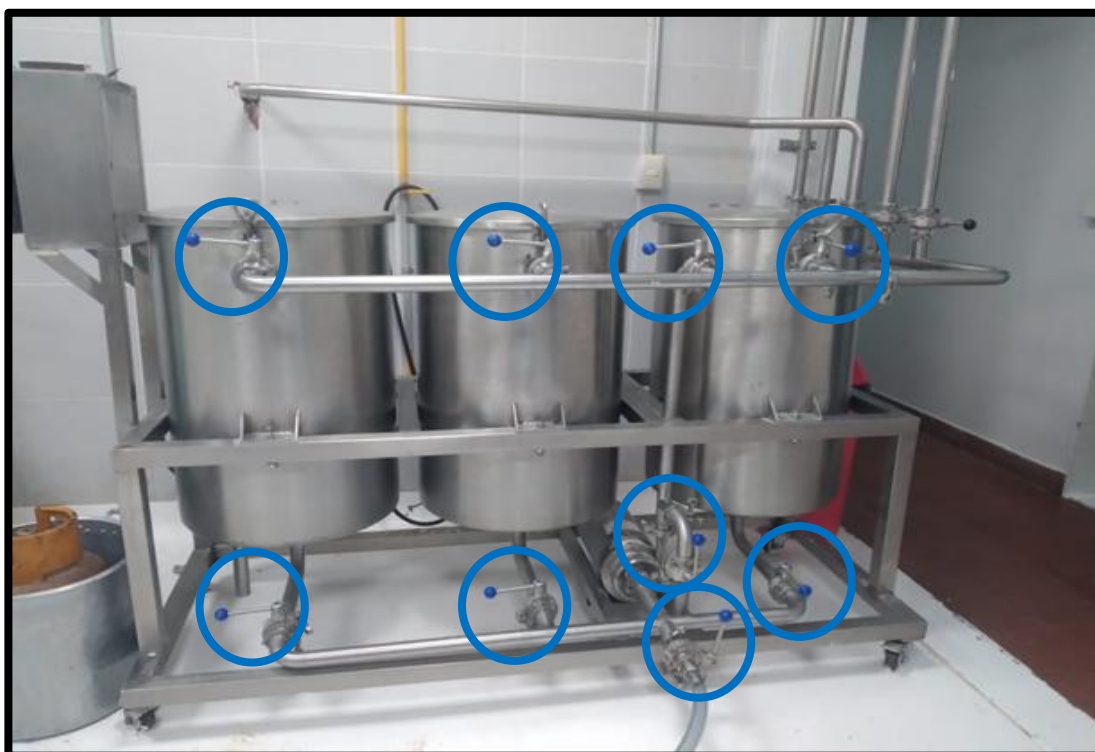
Tanques de limpieza CIP
