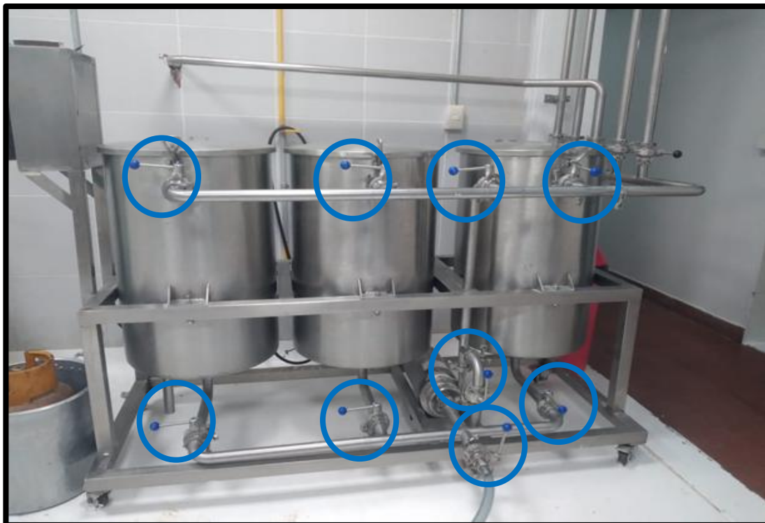
Tanques de limpieza CIP
