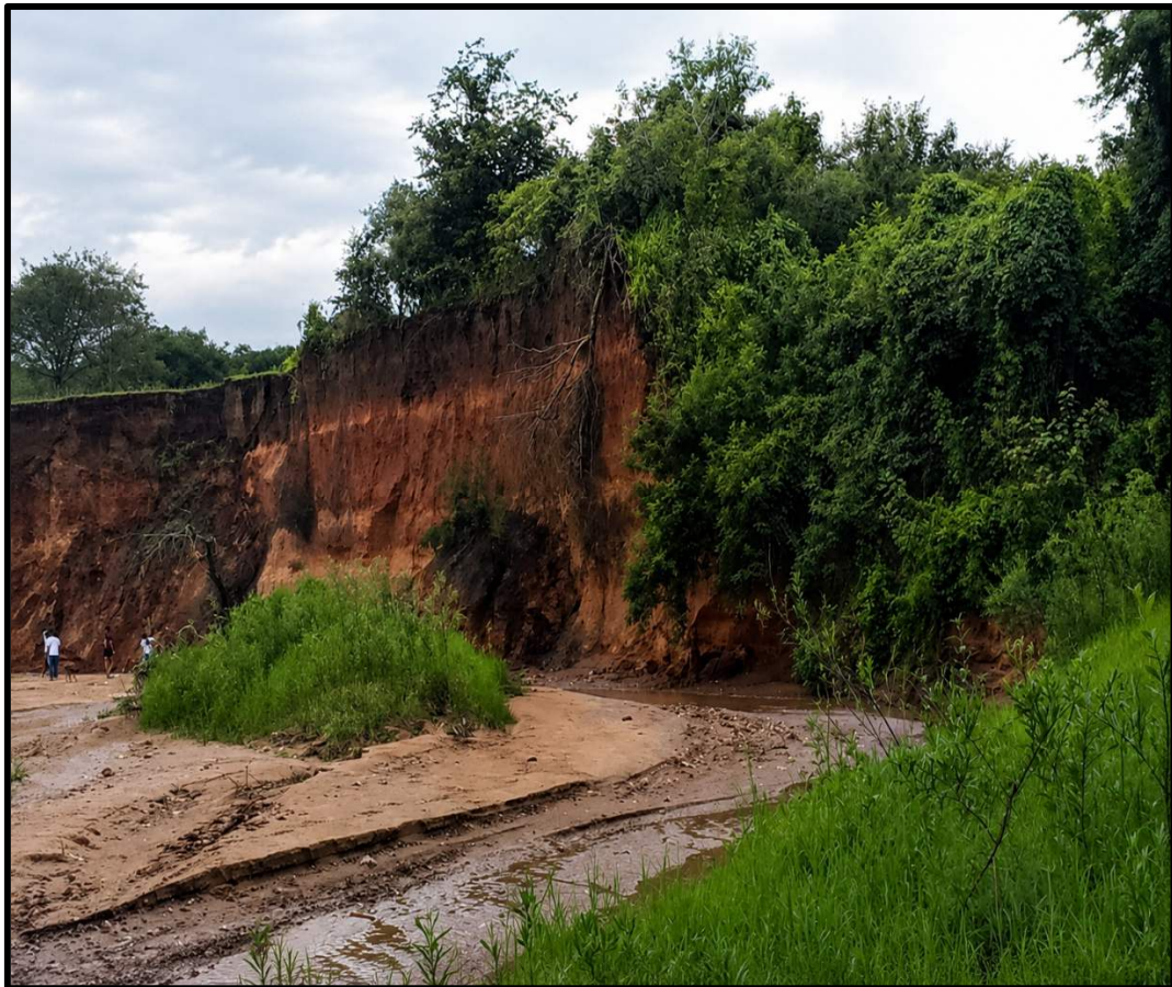
Figura 8. Detalle de inestabilidad de taludes y pérdida de cobertura vegetal en la margen natural de la quebrada.
