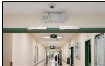
Figura 49: Sistemas de seguridad
