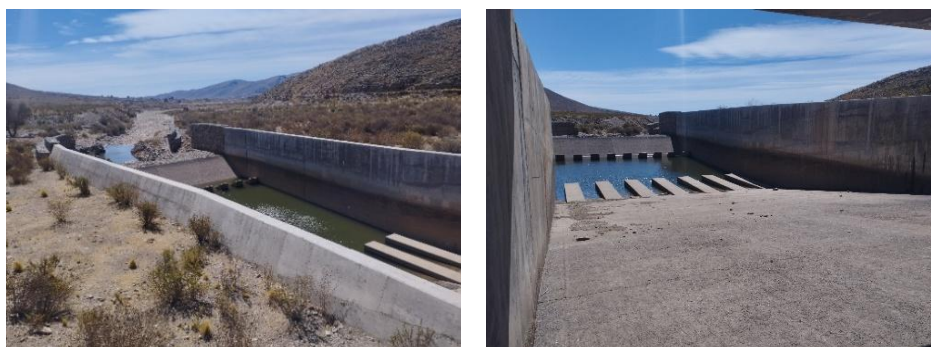
Figura 3.10 Cuenco amortiguador de la presa El Molino
