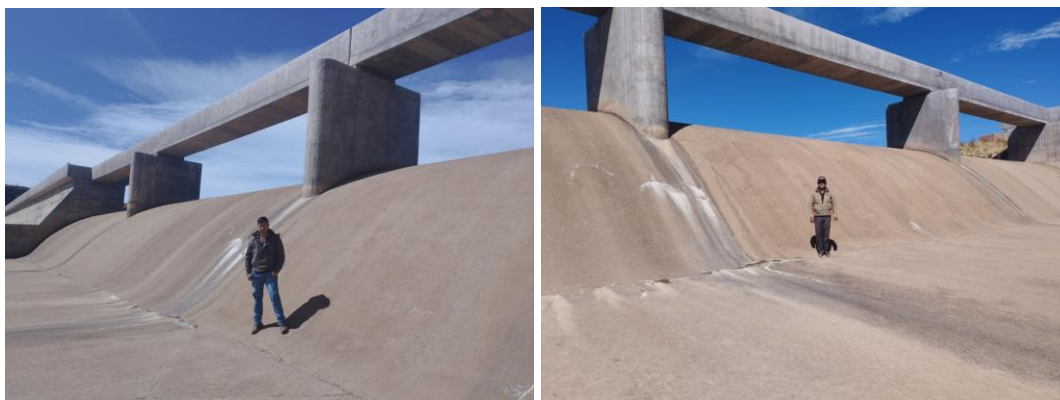
Figura 3.6 Vertedero WES de presa El Molino en época de lluvia y estiaje
