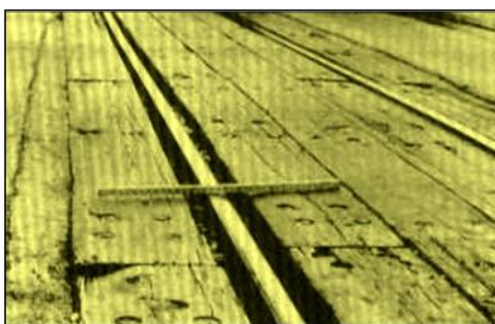
Figura N° 44.- Cruce de vía férrea de severidad media.
