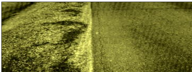
Figura N° 24.- Grieta de borde de baja severidad.
