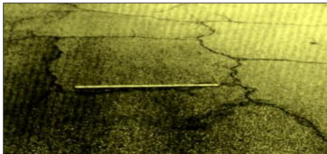
Figura N° 13.- Grietas en bloque de severidad media.
