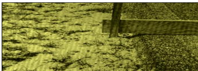
Figura N° 30.- Desnivel carril/berma de baja severidad.
