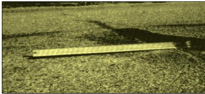
Figura N° 15.- Abultamientos y hundimientos de baja severidad.
