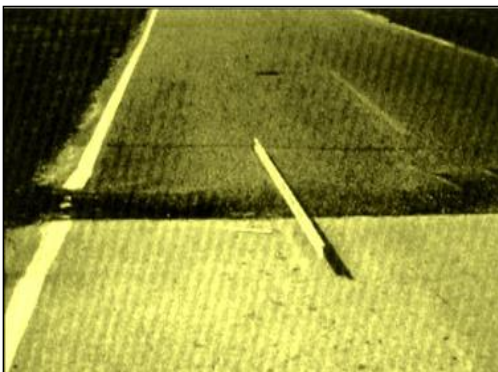
Figura N° 51.- Desplazamiento de severidad alta.
