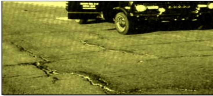
Figura N° 14.- Grietas en bloque de alta severidad.
