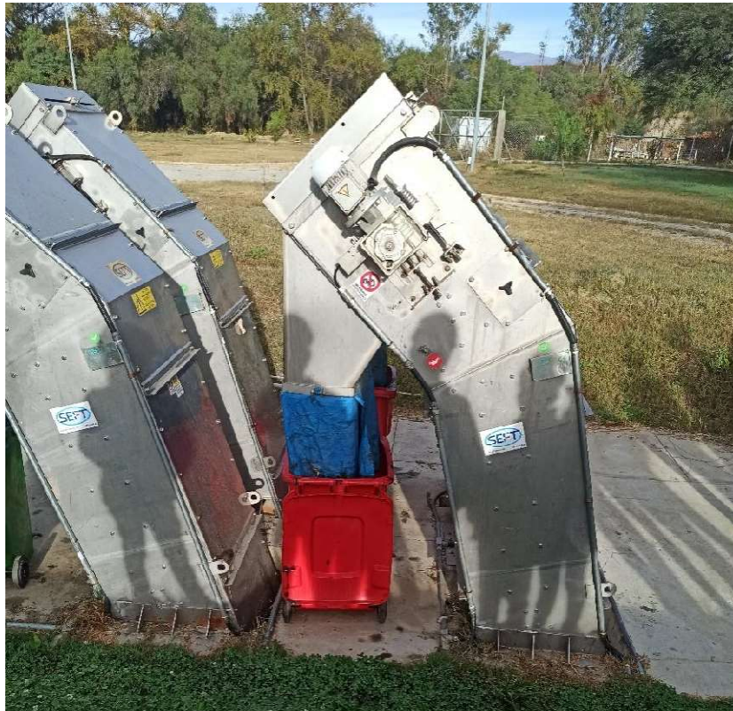
Figura 15. Rejas automáticas de la PTAR San Blas
