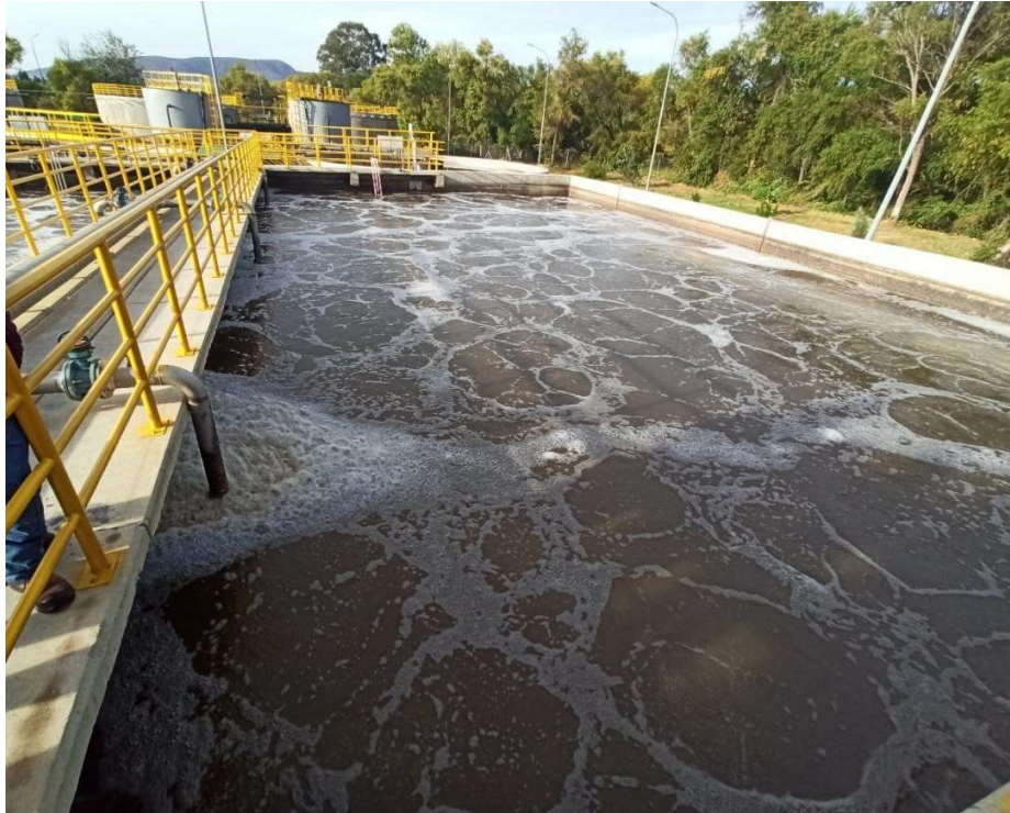
Figura 17. Rector de lodos activados de la PTAR San Blas
