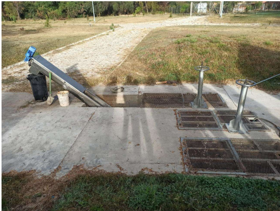
Figura 16. Tornillo de Arquímedes de la PTAR San Blas.
