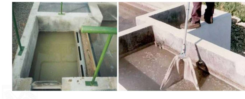
Figura 3. Extracción de grasas mediante tuberías acanaladas y recogedor de grasas.
