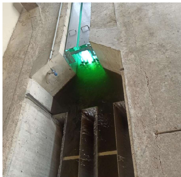
Figura 21. Sistema de desinfección de rayos UV en la PTAR San Blas.
