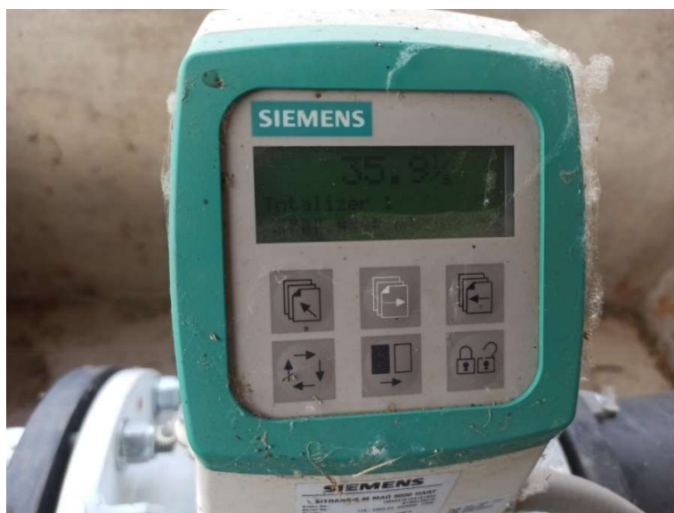
Figura 26. Monitor de caudal del tren B PTAR SAN BLAS
