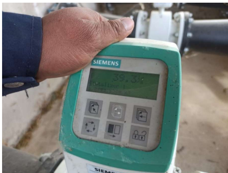
Figura 25. Monitor de caudal del tren A PTAR SAN BLAS
