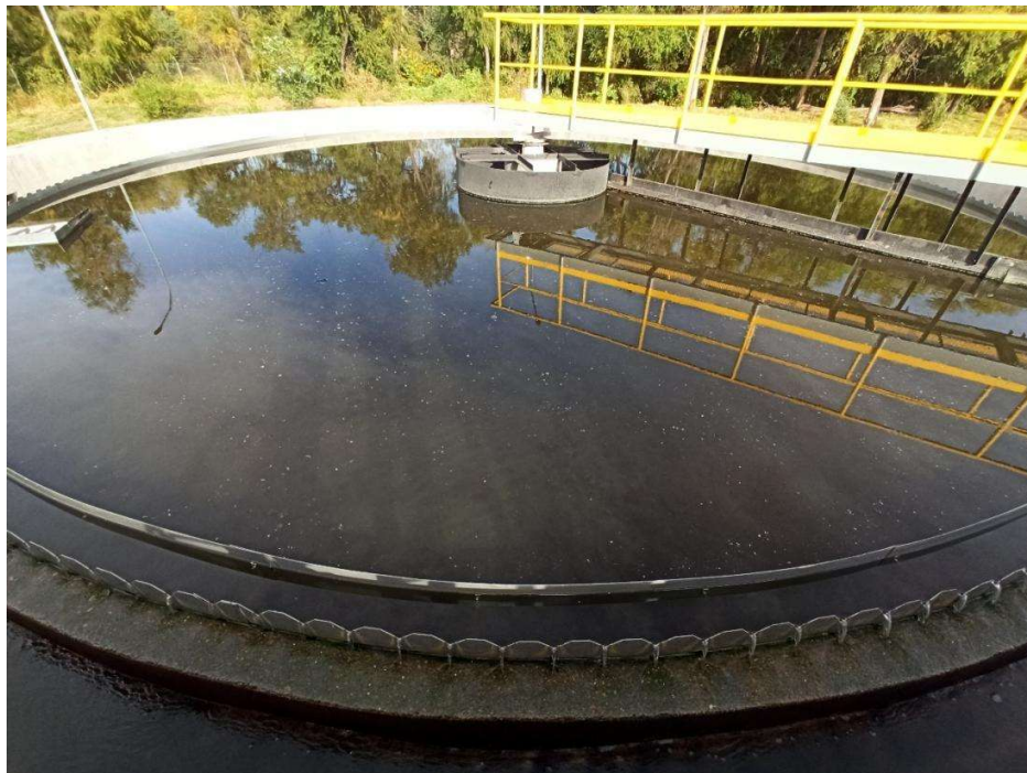
Figura 19. Sedimentador secundario de la PTAR San Blas
