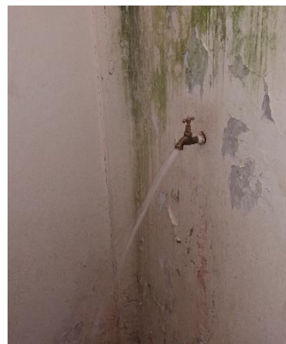
IMAGEN N° 28 PURGA DE AGUA DEL GRIFO
