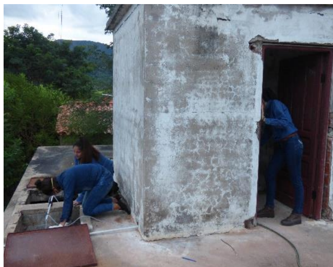
IMAGEN N° 15 REGULACIÓN DE LA VÁLVULA PARA LA DOSIFICACIÓN.
