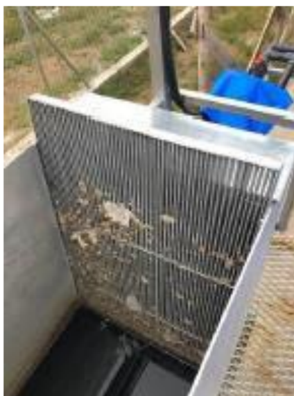
Figura 7. Cámara de rejillas
