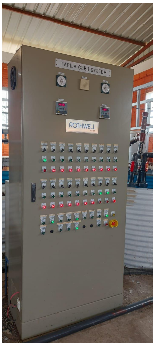
Fotografia 13. Panel de control
