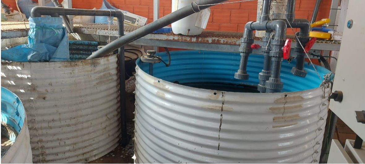
Fotografia 12. Tanque de almacenamiento de lodos y almacenamiento de efluente
