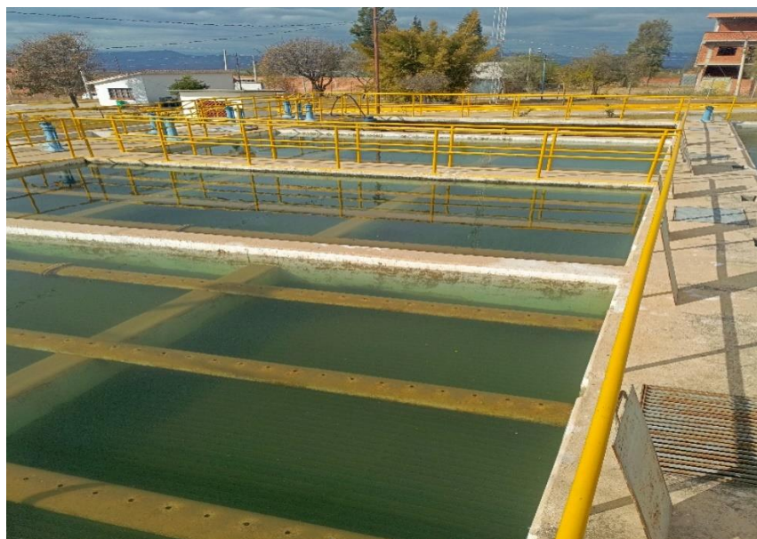
Figura B.2 Vista general de las cuatro (4) unidades de sedimentación de la Planta Potabilizadora de Tabladita.
