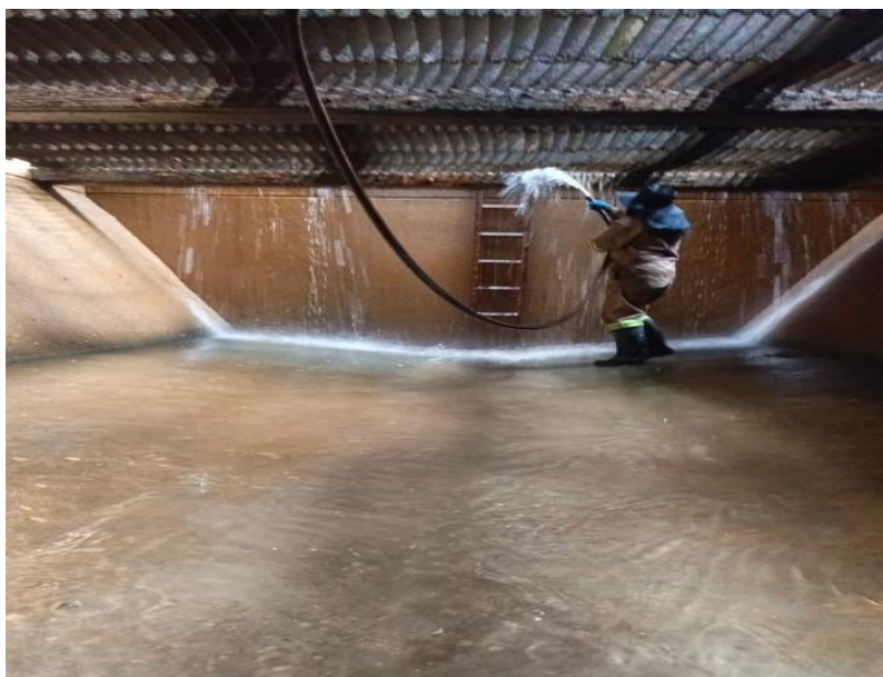
Figura B.3 Vista interna de la zona de entrada del sedimentador durante el proceso de limpieza y mantenimiento
