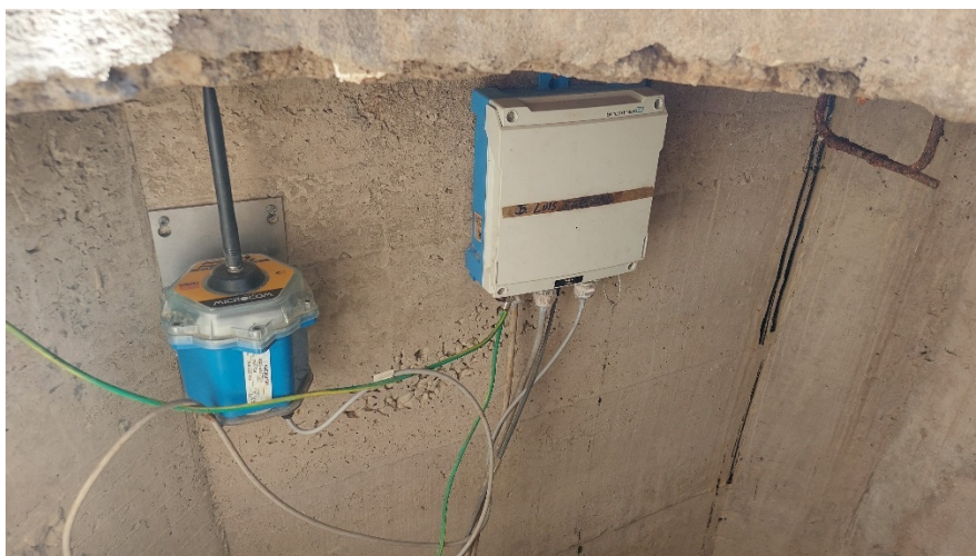
Figura 18 : Sistema de Macro medición (Promag W 800). Fuente: Elaboración propia.
