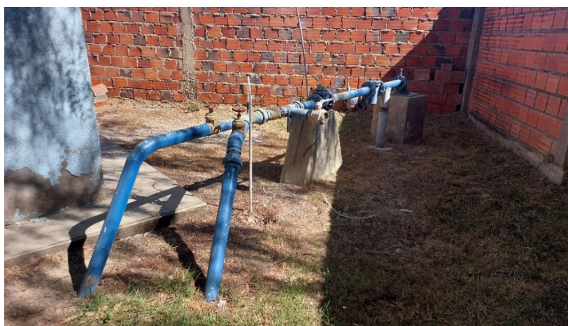
Figura 14 : Pozo Luis Espinal A y tubería de aducción. Fuente: Elaboración propia.
