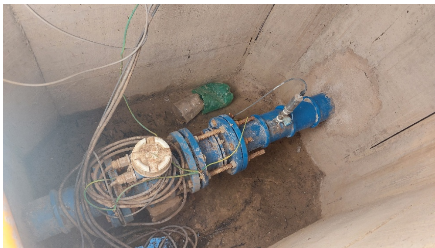
Figura 19 : Tubería de distribución a la red. Fuente: Elaboración propia.
