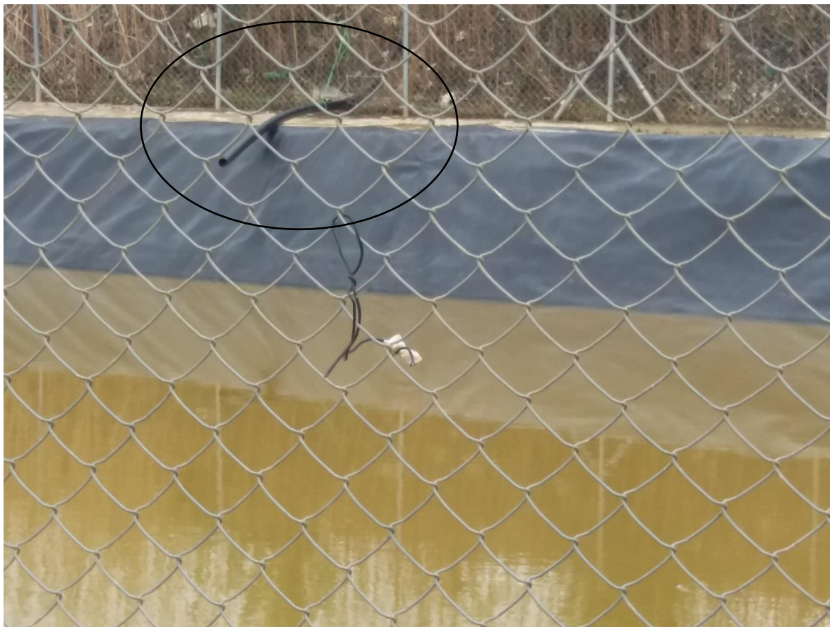
Tubo de descarga de aguas lixiviadas.
