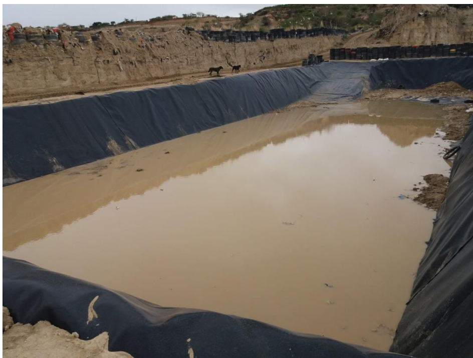
Nueva celda de residuos sólidos inundada.
