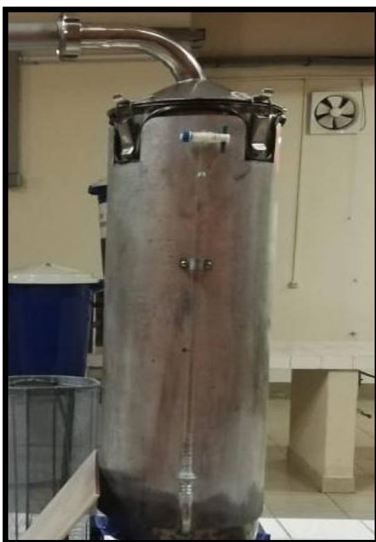
Foto 2- 13: Cámara de extracción
