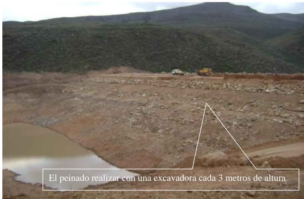
FIGURA6.20 PROTECCIÓN TALUD PEDRAPLEN PRESA CASA VIEJA "CHIGUAYPOL"
