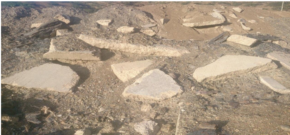
Ilustración 4 Residuo de las losas de hormigón
