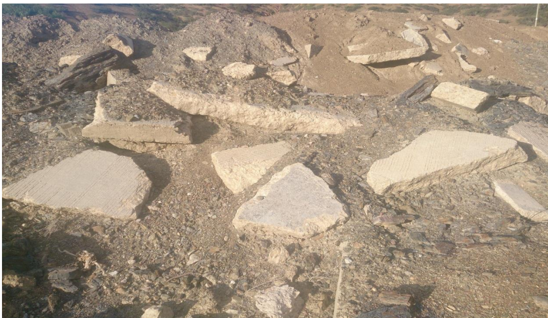
Figura 1.2: Residuos de las losas cambiadas
