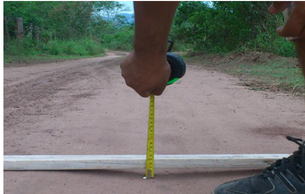
Imagen 6 Medición de ahuellamiento
