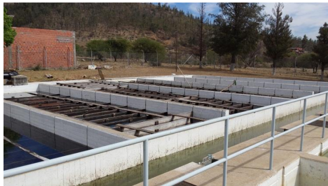
Figura 3.1 Planta de tratamiento de agua potable (Zona Tabladita)
