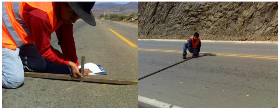
Figura 3.45. Medición de ahuellamiento
