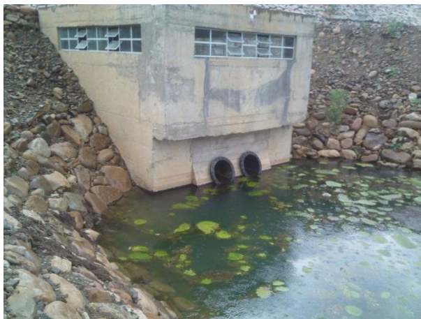
Figura 5.7: Descargador de fondo de la presa de Calderas
