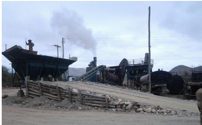
Figura N° 2.12 Planta de Asfaltos
