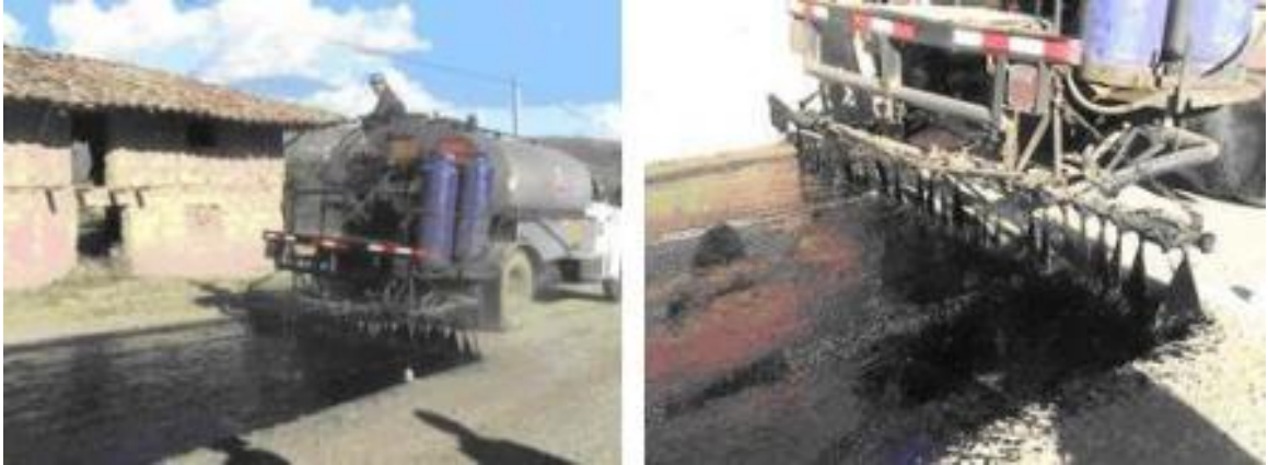
Figura N° 2.3 Asfaltos cortados o diluidos
