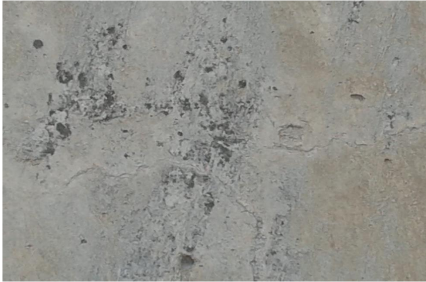
FOTOGRAFÍA III-20 FISURAS EN FORMA DE CRAQUELADO Y CON COLORACIONES- PRESA SAN JACINTO
