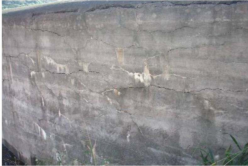
FOTOGRAFÍA III-17 VERTEDERO DE DIQUE EL CADILLAL FUENTE: Ing. Silvia Palazzi; Ing. Daniel Anaya "PAUTAS PARA LA UTILIZACIÓN DE AGREGADOS REACTIVOS A LA REACCIÓN ÁLCALIS- SÍLICE EN ESTRUCTURAS DE HORMIGÓN".
