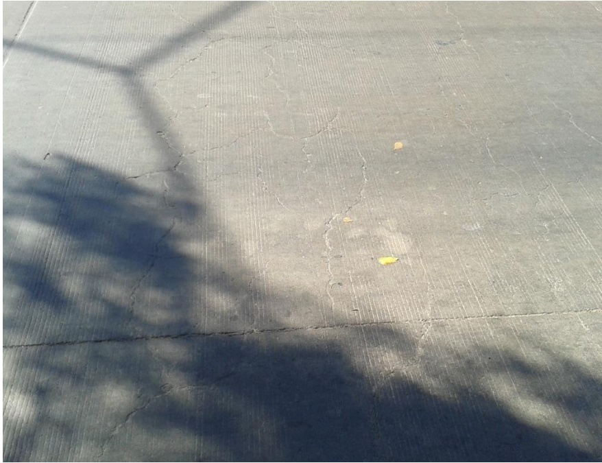
FOTOGRAFÍA III-22 AVENIDA CIRCUNVALACIÓN-FISURAS EN FORMA DE CUÑA FUENTE: Elaboración propia
