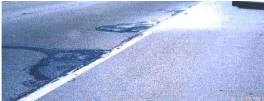
Figura 2.16. Bombeo de finos en pavimentos asfálticos. Fuente: Capítulo 3 “Mezclas Asfálticas”, Alejandro Padilla Rodríguez.
