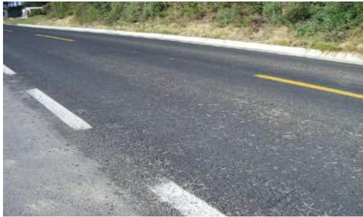
Figura 2.13. Exudación en pavimento asfáltico. Capítulo 3 “Mezclas Asfálticas”, Alejandro Padilla Rodríguez.
