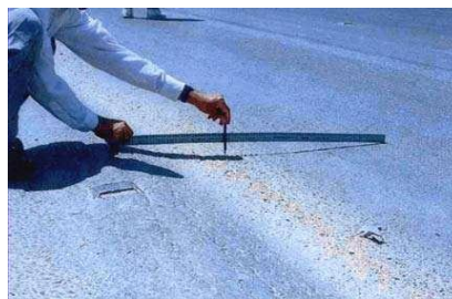
Figura 2.17 Deformación plástica permanente en pavimento asfáltico. Fuente: Capítulo 3 “Mezclas Asfálticas”, Alejandro Padilla Rodríguez.
