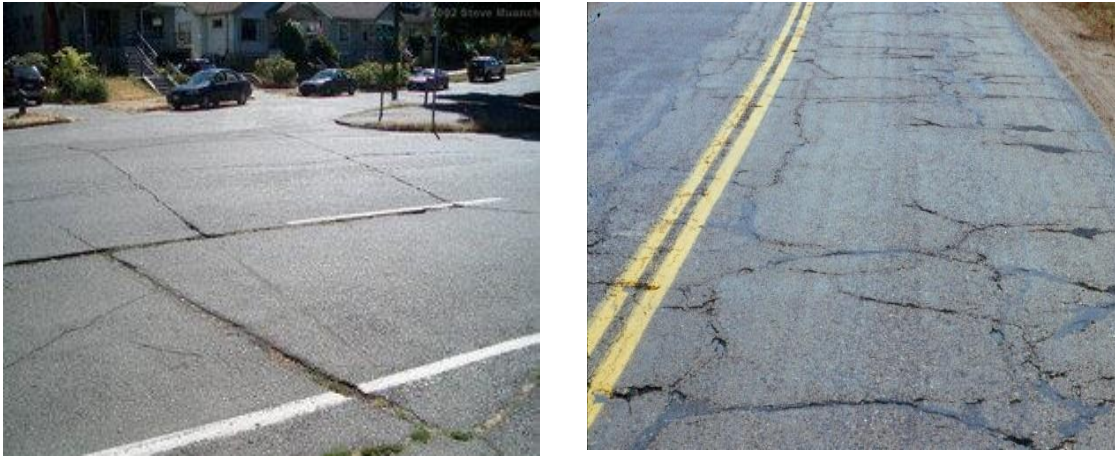
Figura 2.12 Fallos en la Construcción de pavimentos asfálticos. Fuente: Capítulo 3 “Mezclas Asfálticas”, Alejandro Padilla Rodríguez.
