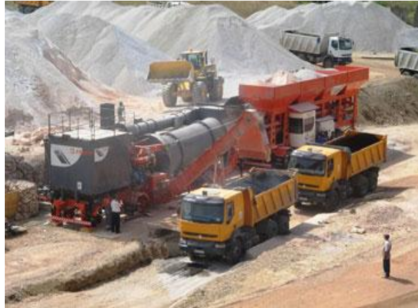
Figura 2.6: Planta de Asfalto Continua. Fuente: https://www.google.com.bo/search?q=plantas+de+asfalto+continuas&espv=2&source
