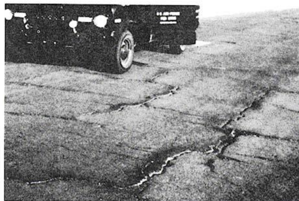
Figura B-3.c. Agrietamiento en bloque Alta-severidad.
