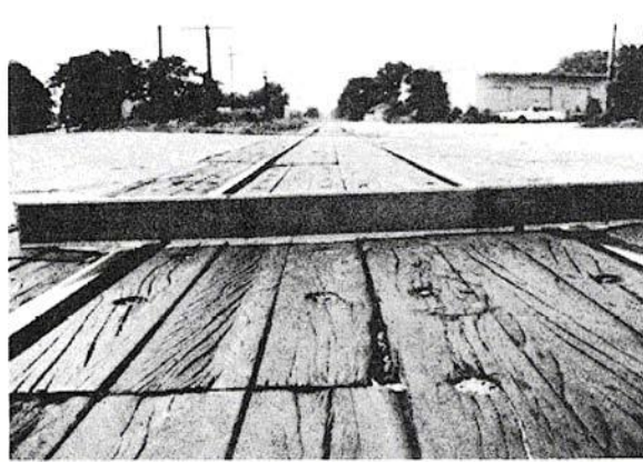
Figura B-14.a. Cruce de Ferrocarril Baja-severidad.
