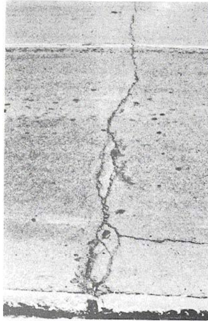
Figura B-8.b. Agrietamiento Reflejo de Juntas Media-severidad.
