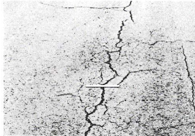
Figura B-10.b. Agrietamiento Longitudinal y transversal Media-severidad.
