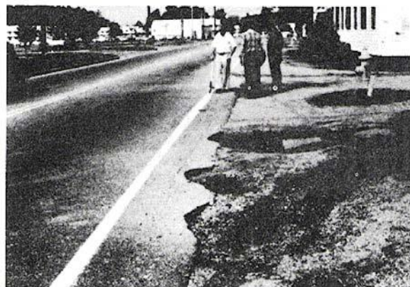
Figura B-7.c. Agrietamiento de Borde Alta-severidad.
