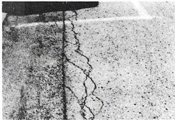
Figura B-7.b. Agrietamiento de Borde Media-severidad.
