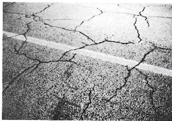
Figura B-3.b. Agrietamiento en bloque Media-severidad.
