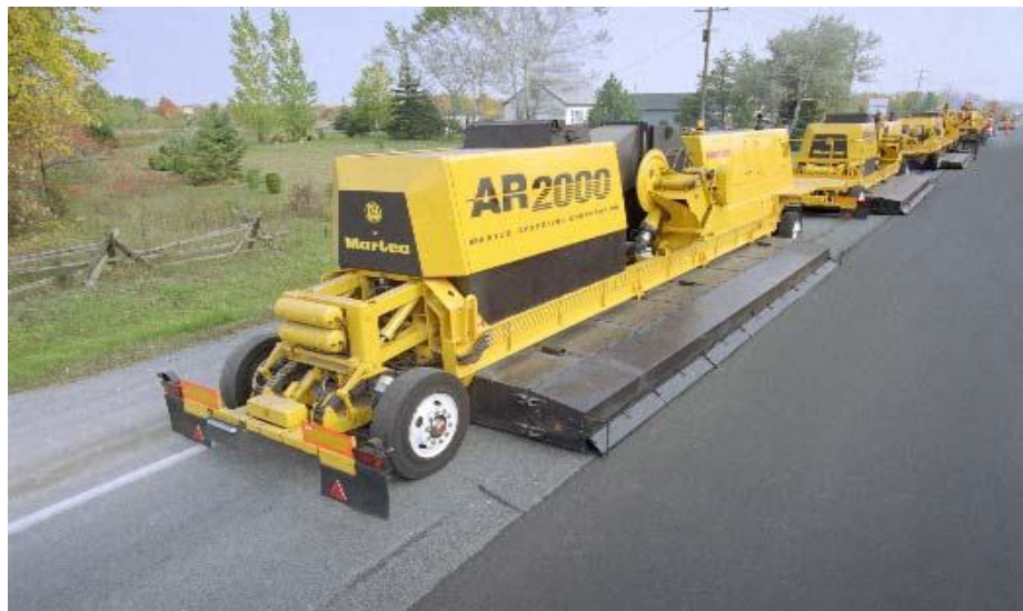
Tren de reciclado en caliente in situ (Fuente: Martec Recycling Corporation www.martec.ca ).
