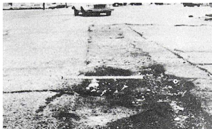
Figura B-11.c. Parchados Alta-severidad.
