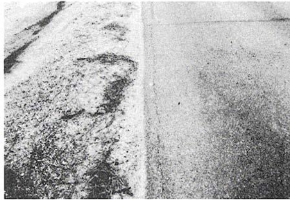
Figura B-7.a. Agrietamiento de Borde Baja-severidad.
