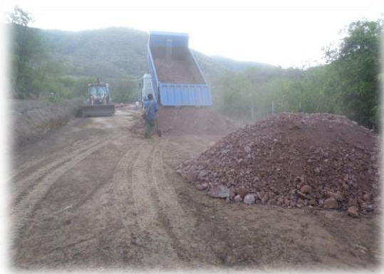
FIGURA N°54 Material de ripio en la calzada
