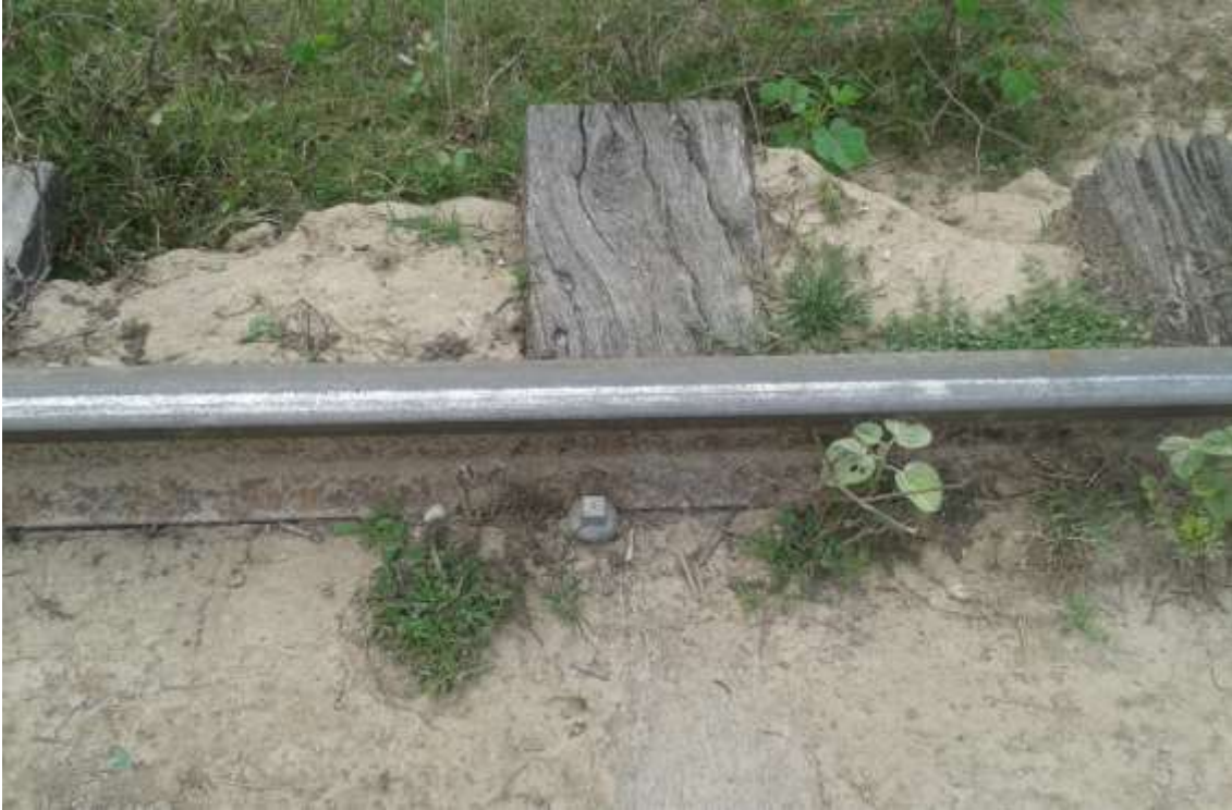
Figura 31. Tramo progresiva 17+000 durmientes no enterradas.
