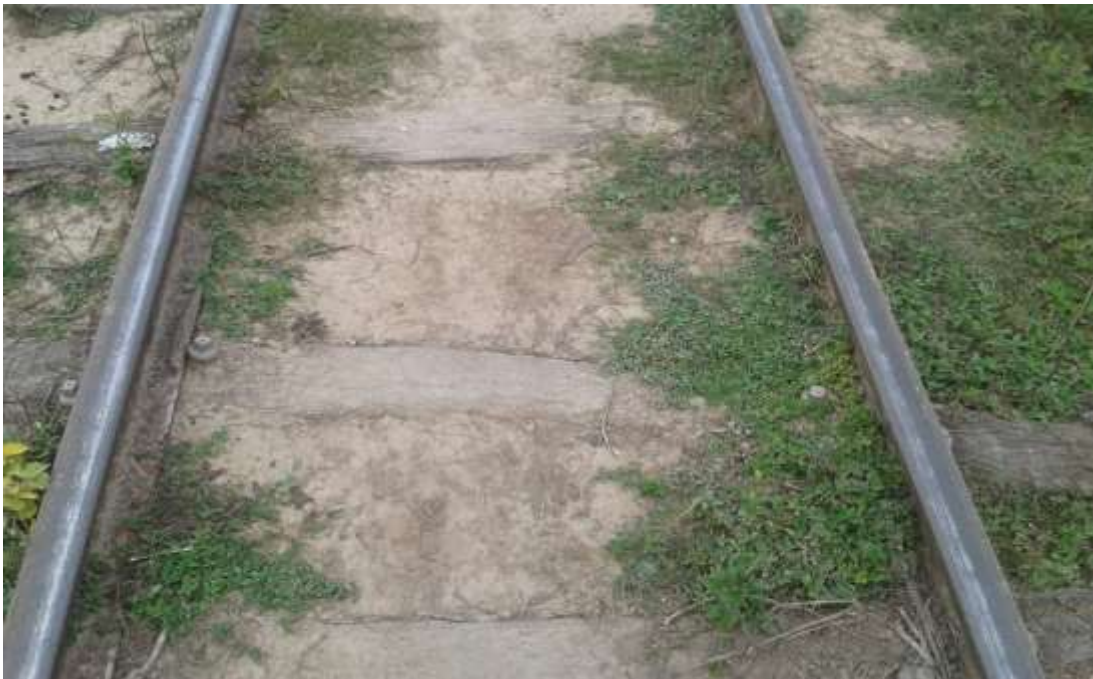
Figura 32. Tramo progresiva 19+000 durmientes con curvatura vertical.
