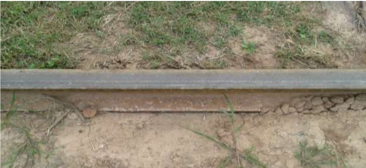
Figura 33. Tramo progresiva 10+000 rieles levantados.
