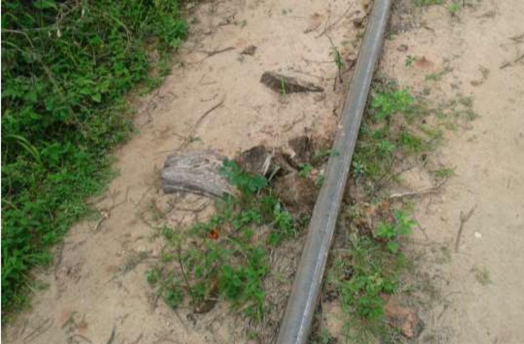
Figura 29. Tramo progresiva 11+000 durmientes destruidas.
