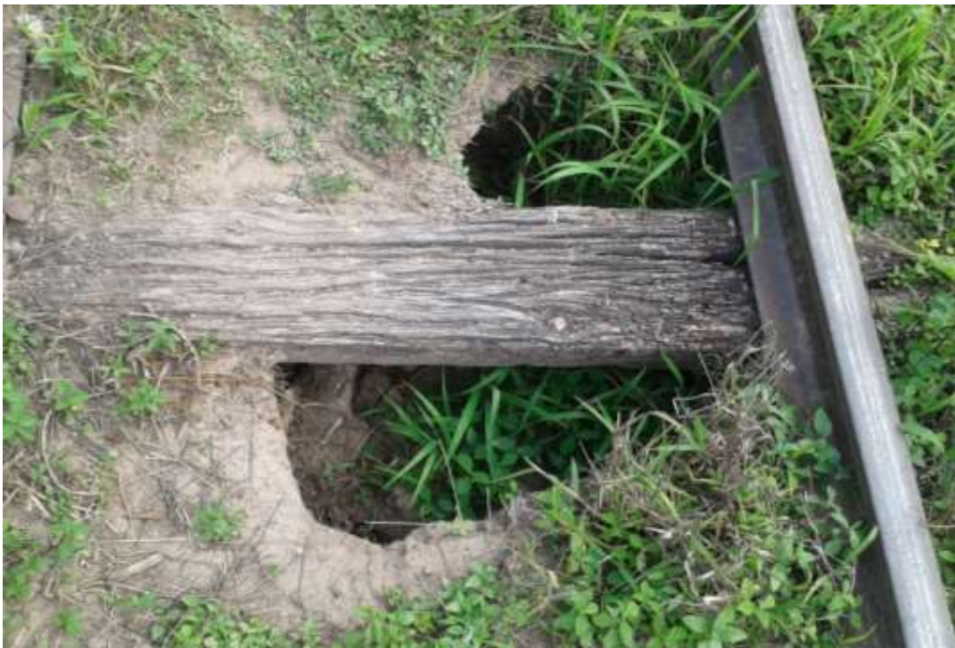
Figura 30. Tramo progresiva 13+000 durmientes.
