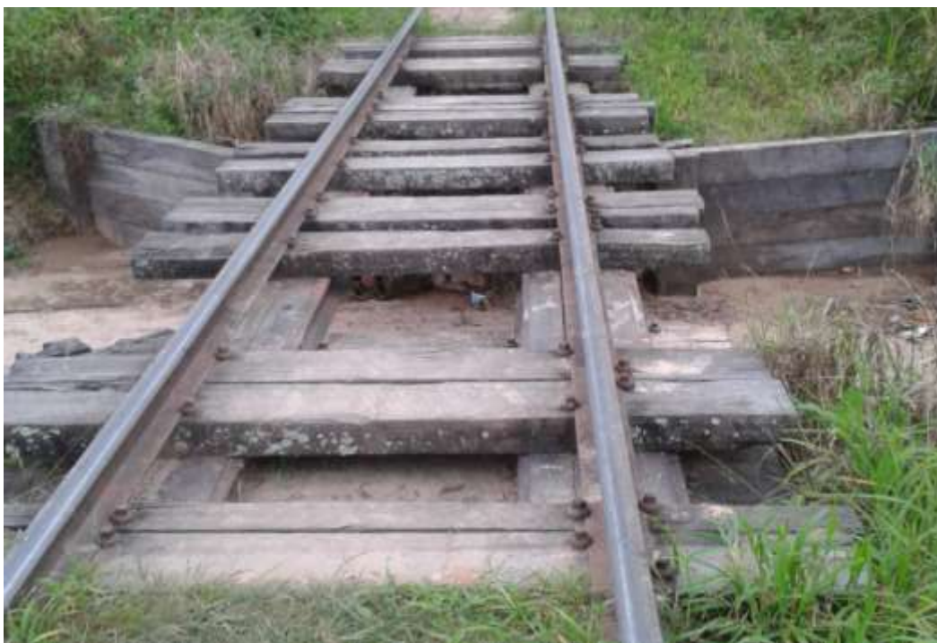
Figura 38. Alcantarilla cajón con falta de durmientes.
