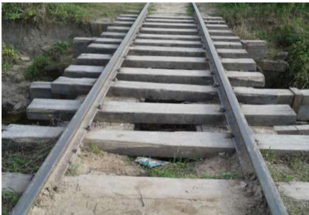
Figura 36. Puente provisorio Castillo prog. 9+000. Durmientes desniveladas.
