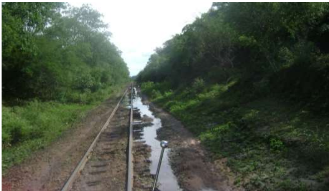
Figura 35. Problemas de drenaje en el 2011 en el kilómetro 17.
