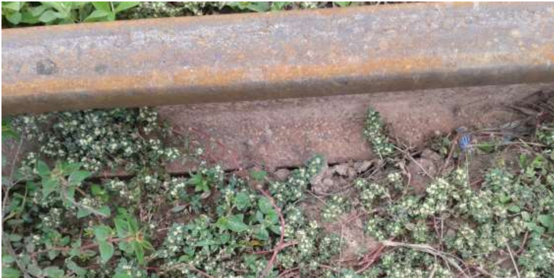
Figura 34. Tramo progresiva 17+000 rieles oxidados.
