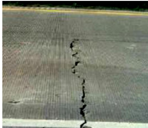
Figura 2.15. Fatiga a la Flexión en losas de pavimentos rígidos
