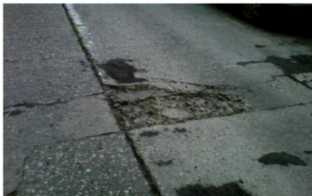
Figura 2.13. Fisura en una losa por causa de exudación
