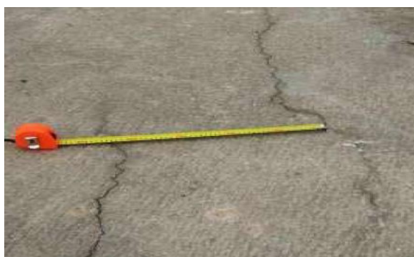
Figura 2.10. Fisuras por asentamiento plástico en una losa de pavimento rígido
