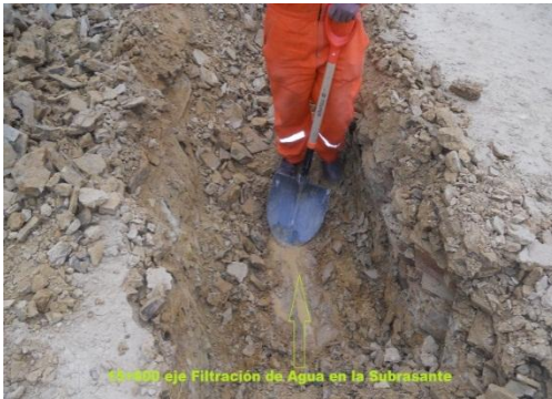
Fotografía III-36 Filtración de Agua en la Subrasante
