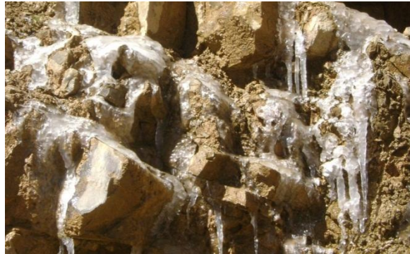
Fotografía III-37 Agua congelada en talud Prog:12+800
