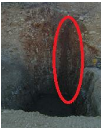
Fotografía III-40 Filtración de Agua por el Talud
