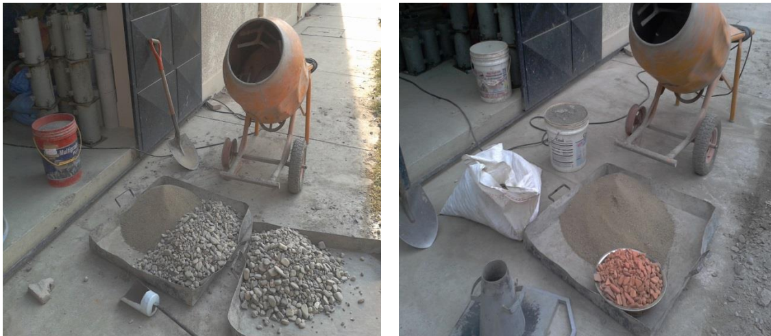
FIGURA 3.2.9-1: MATERIALES YA PESADOS Y LISTOS PARA LA ELABORACIÓN DE LAS MEZCLAS DE HORMIGÓN
